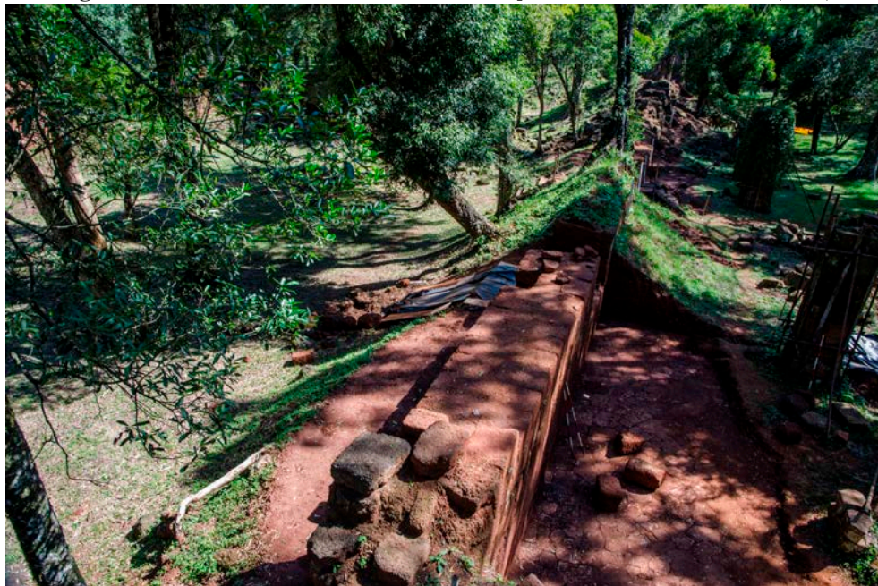
Figura 2. Los trabajos en el muro norte del Templo de Ntra. Sra. de Loreto (2012)
