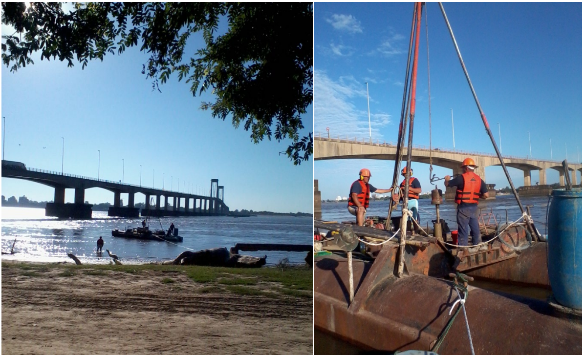
Figura N°3.4. Sondeo sobre el río Paraná. (Fuente:UTE) Figura N°3.5. Sondeo sobre el río Paraná.
