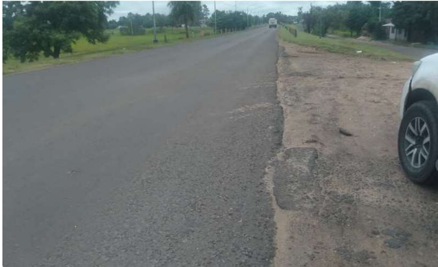
Imagen 6. Ausencia de Señalizaciones. Fuente: VR Ingeniería Civil
