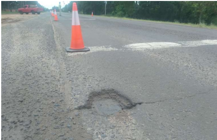
Imagen 4. Desprendimiento severo de material – Fuente (VR Ingeniería Civil)
