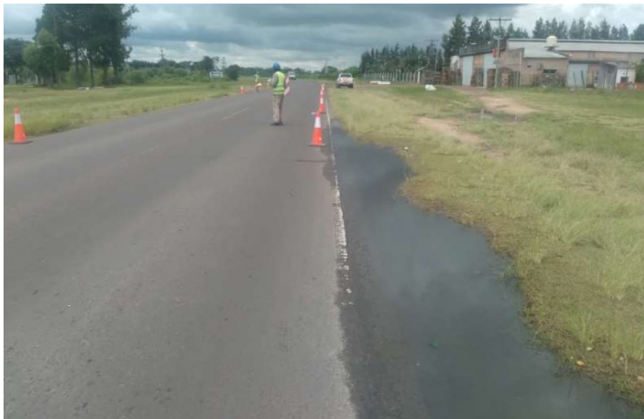
Imagen5. Banquina hundida con agua – Fuente (VR Ingeniería Civil)
