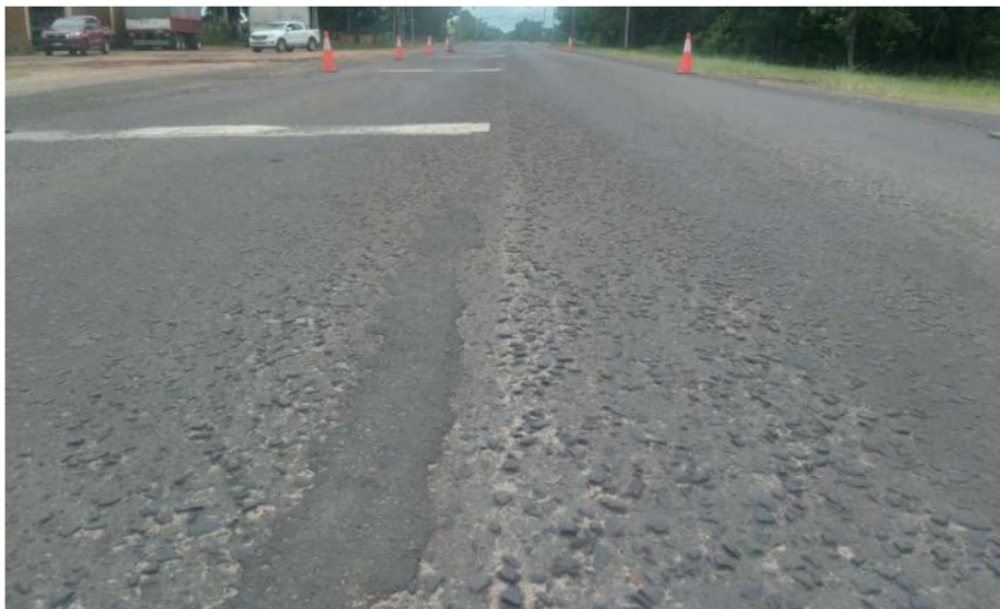
Imagen3. Desprendimiento de Asfalto por envejecimiento - Fuente (VR Ingeniería Civil)
