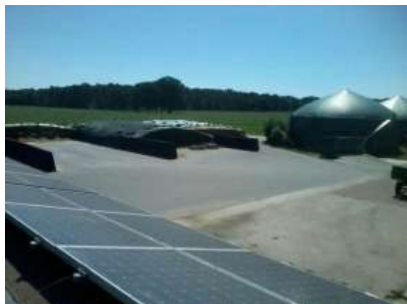
Foto 5: Paneles solares sobre el techo del galpón
