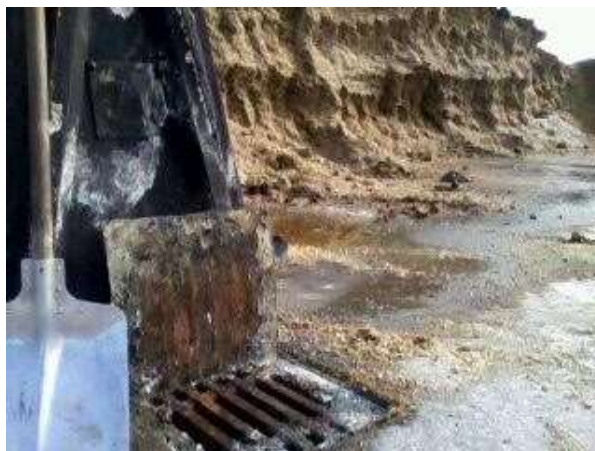
Foto 72: Desague para el escurrimiento de los efluentes del silo y evitar la contaminación de las napas freáticas
