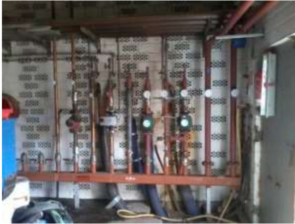
Foto 53: Sistema de calefacción para el fermentador
