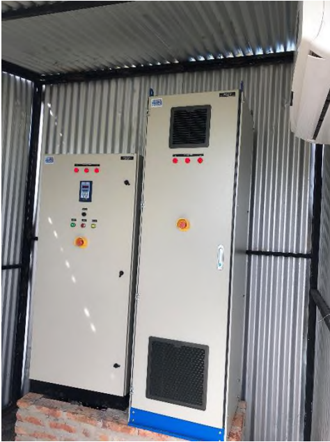
Figura N°4: Tablero eléctrico del motor, bajo techo, con aire acondicionado.
