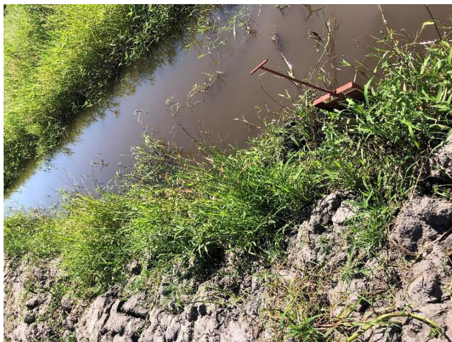
Figura N° 13: Compuerta en canal para entrada de agua al lote.
