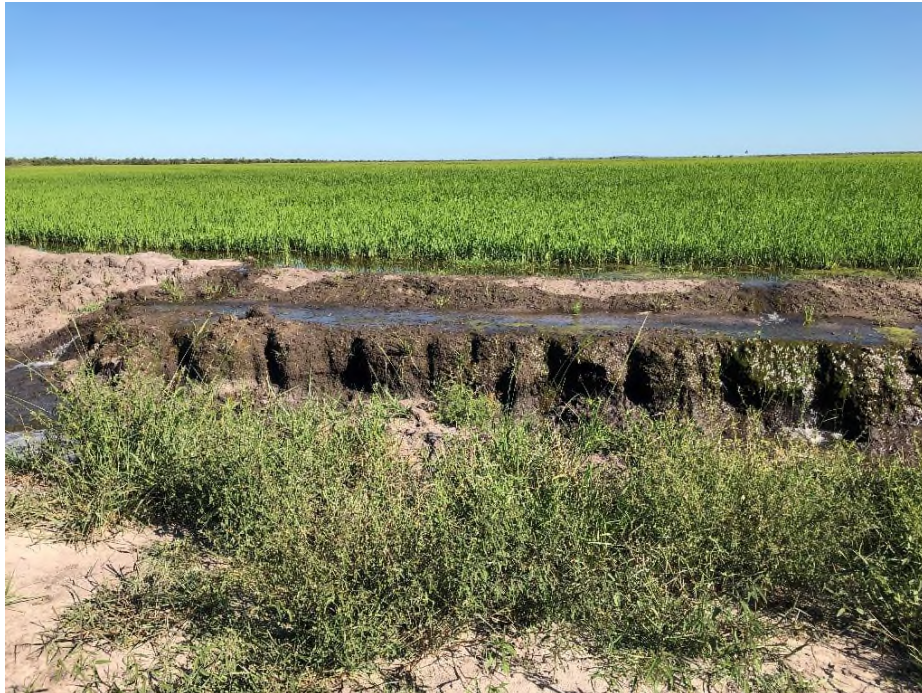
Figura N° 36: pérdidas de agua por roturas de rondas.
