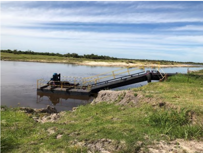
Figura N°5: Estación de bombeo, sobre el Río Corriente.
