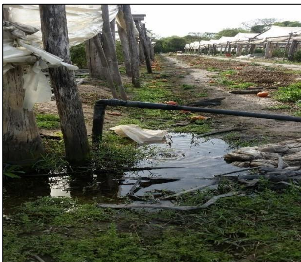
Foto 4 Cañerías de riego con pérdidas.
