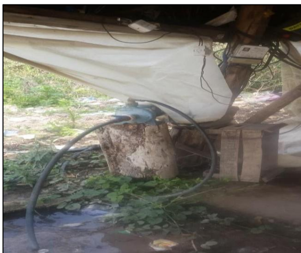
Foto 5 Bomba para extracción de agua con pérdidas.
