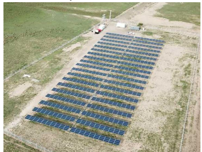
Figura 3. Vista general, tomada a través de un dron, de la microrred híbrida solar/Diesel/batería localizada en Paraje Malvinas Corrientes.
