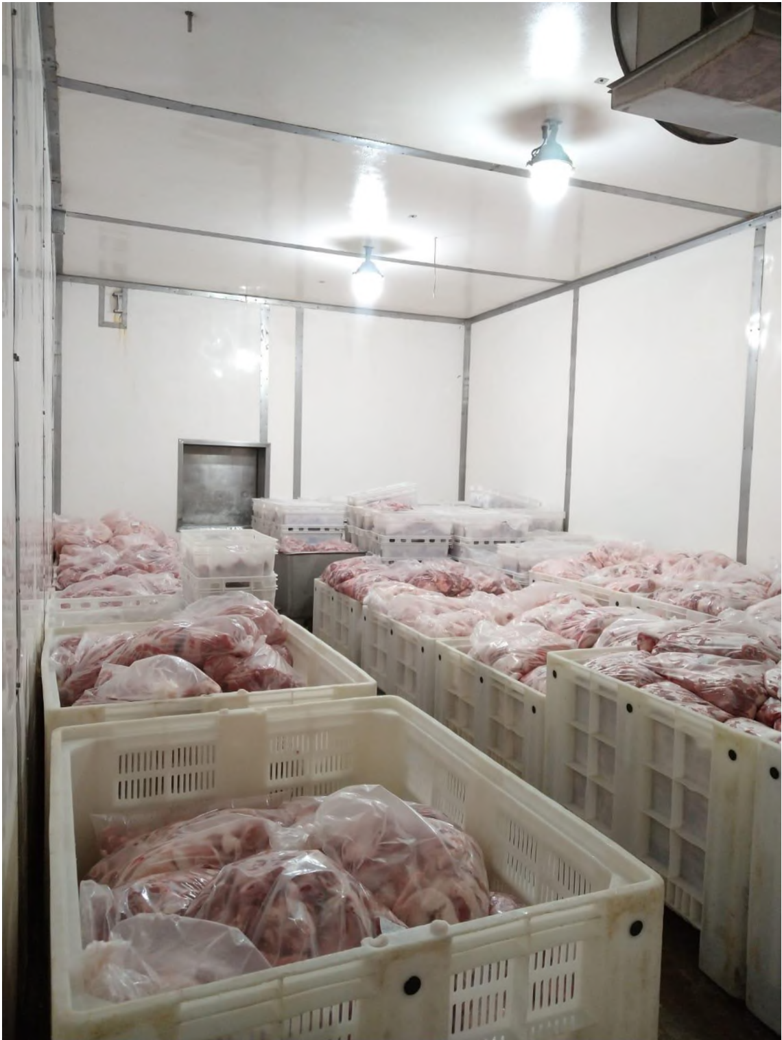
Figura 10 y 11: “Cámara de refrigeración”
