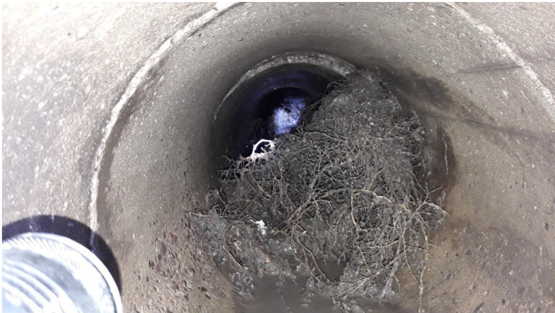
Imagen 29. Conductos del Colector 2 frente a la Facultad de Ciencias Económicas obstruidos por raíces de árboles circundantes (Fuente: Departamento de Mantenimiento-UNNE, 2018).
