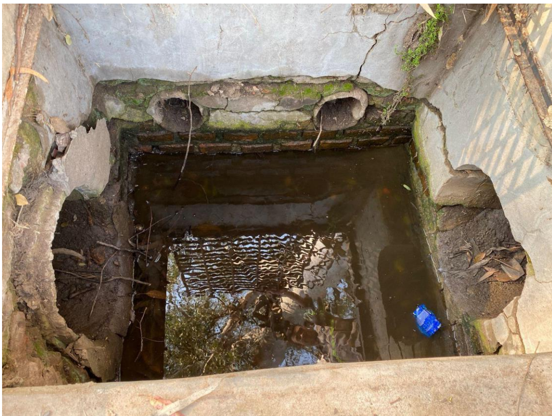
Imagen 2. Conductos fisurados (Fuente: Fotografía propia, 2023).
