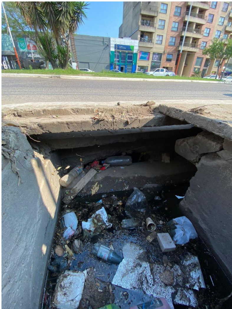
Imagen 27. Falta de mantenimiento y obstrucción por caño de agua potable en la salida del sistema pluvial por Av. Las Heras (Fuente: Fotografía propia, 2023).
