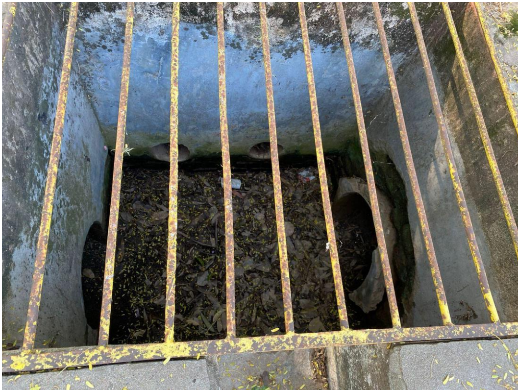
Imagen 1. Conductos obstruidos debido a la falta de limpieza de los mismos (Fuente: Fotografía propia, 2023).
