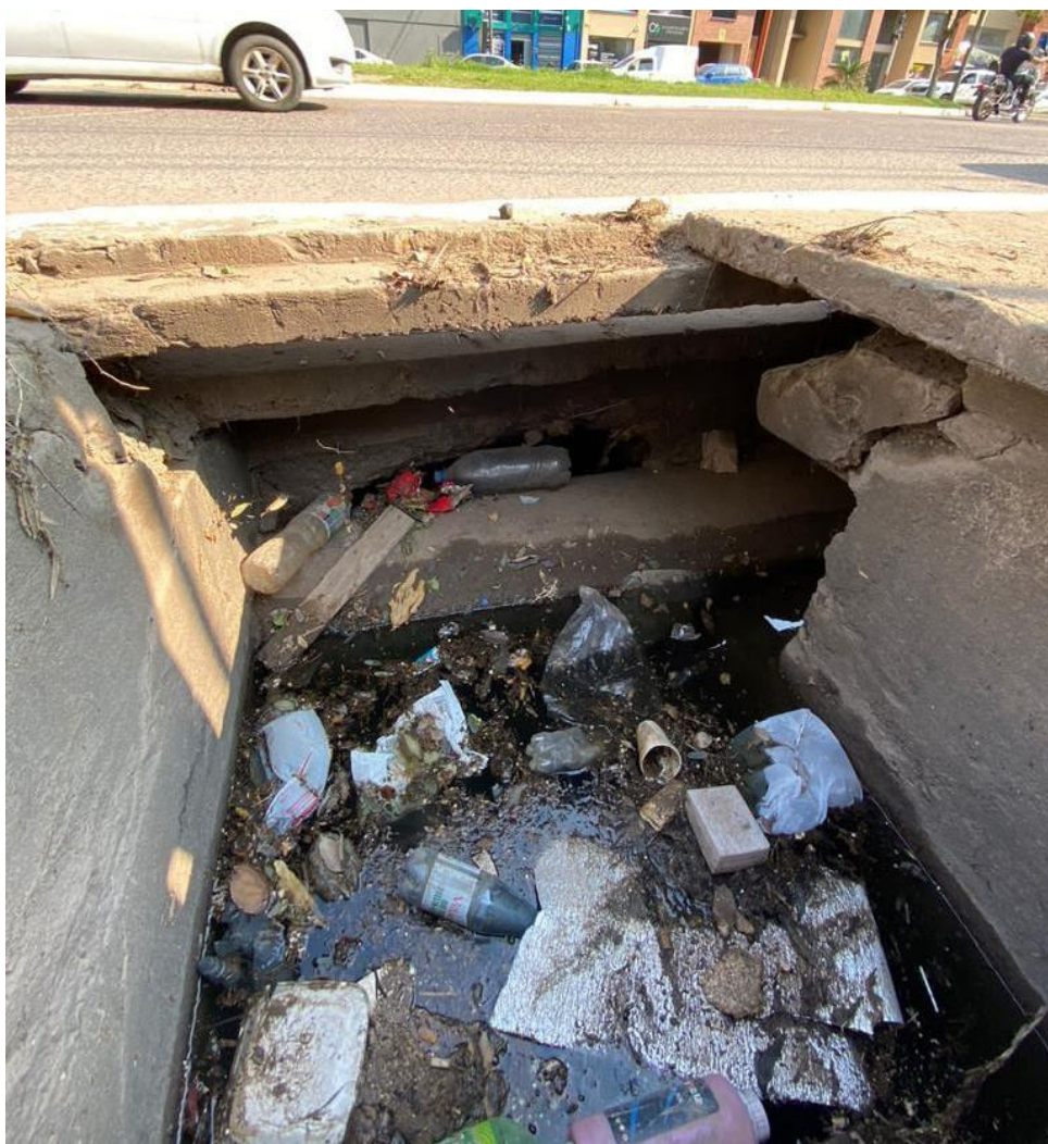
Imagen 3. Falta de mantenimiento y obstrucción por caño de agua potable en la salida del sistema pluvial por Av. Las Heras (Fuente: Fotografía propia, 2023).
