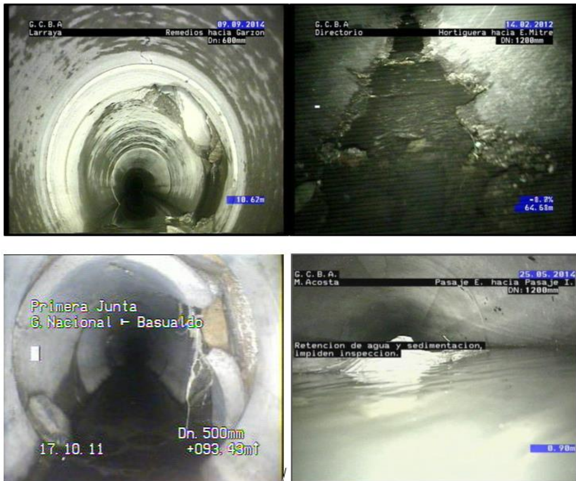
Imagen 14. Visión del estado de la cañería proporcionado por la inspección televisada (Fuente: Forever Pipe,2023).
