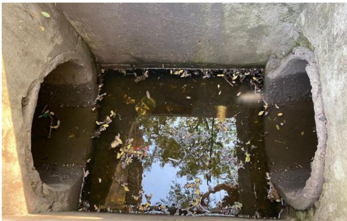
Imagen 31. Cámara 12 del Colector 1 en buenas condiciones (Fuente: Fotografía propia, 2023).
