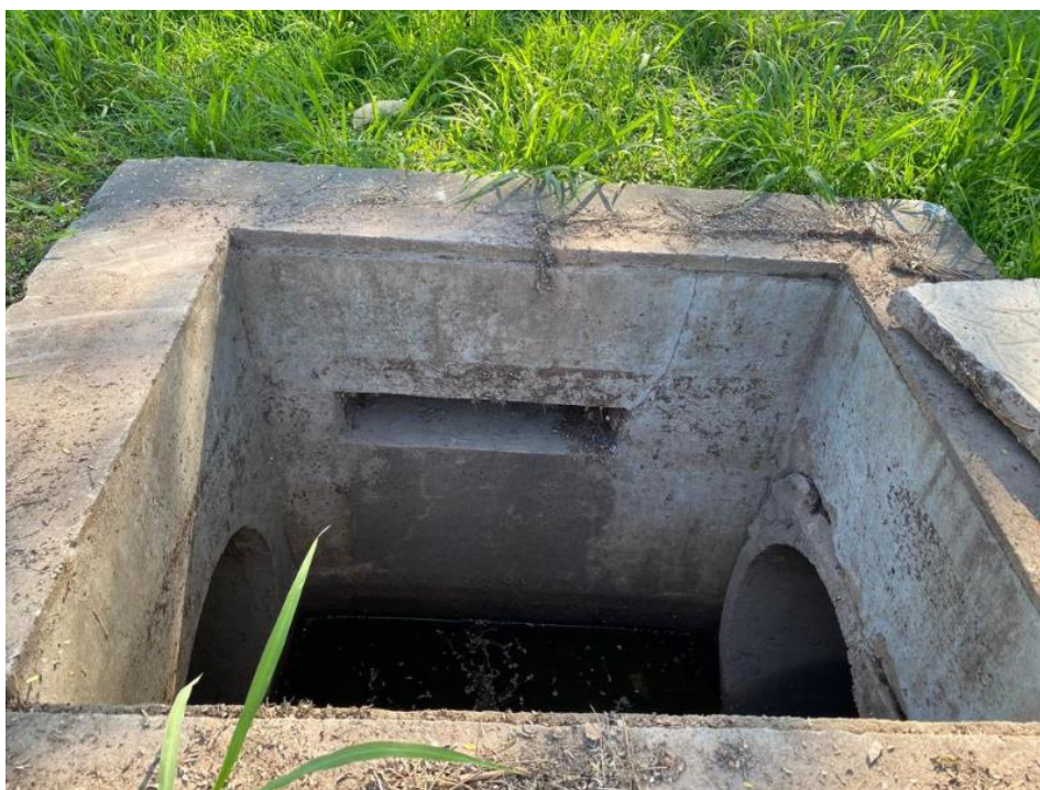
Imagen 30. Cámara 12 del Colector 1 en buenas condiciones (Fuente: Fotografía propia, 2023).
