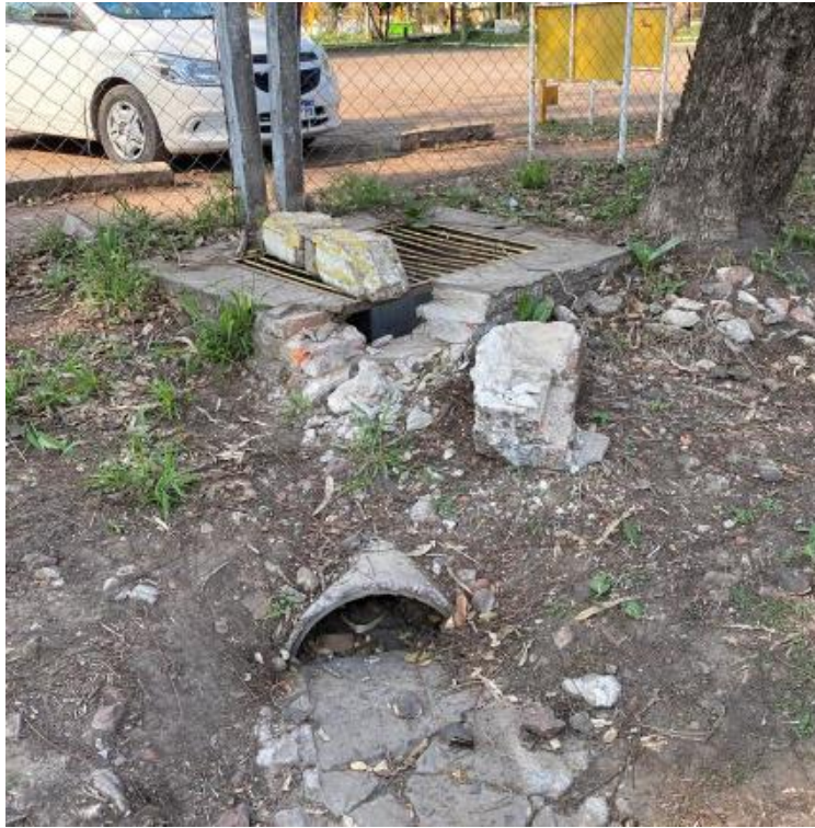
Imagen 28. Cámara 5 del colector 2 en malas condiciones (Fuente: Fotografía propia, 2023).
