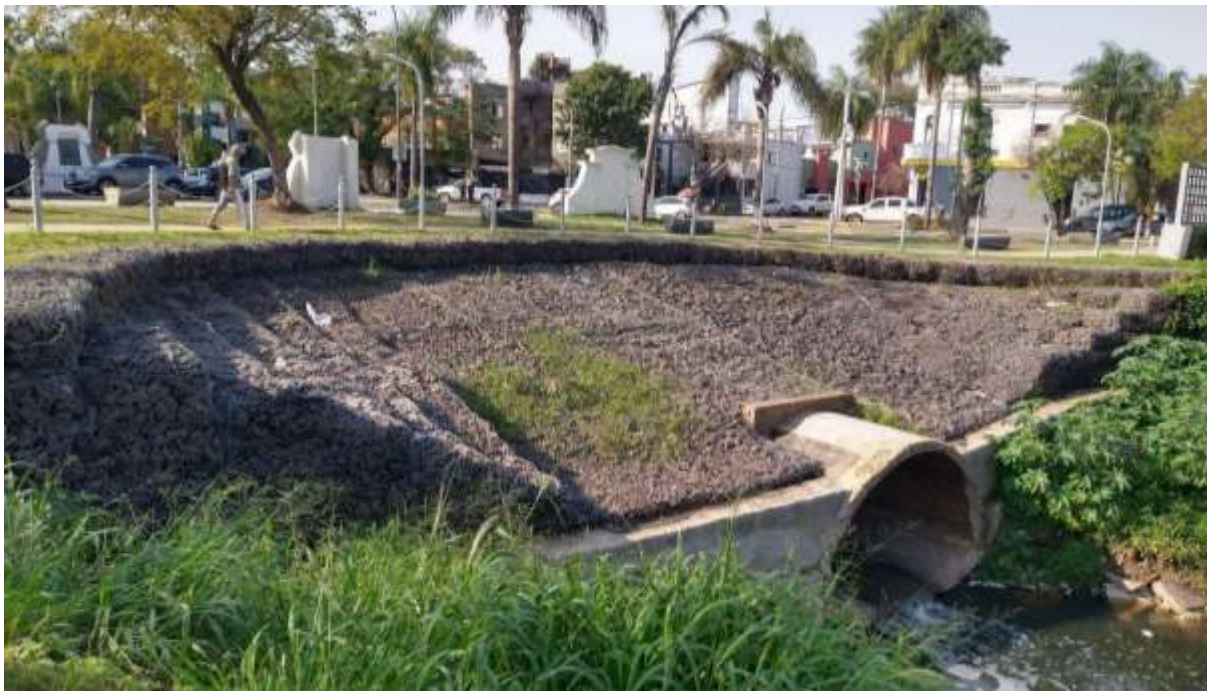
Imagen 2.2 Fotografía de la obra de revestimiento sobre la alcantarilla del arroyo Poncho Verde. (Fuente: Propia)
