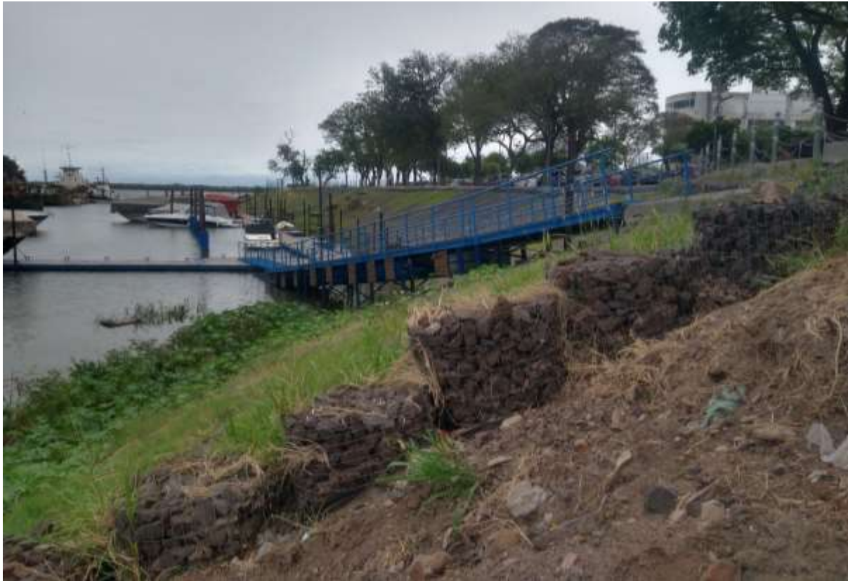
Imagen 2.3 Fotografía de la obra de revestimiento del talud este, aguas abajo. (Fuente: Propia)
