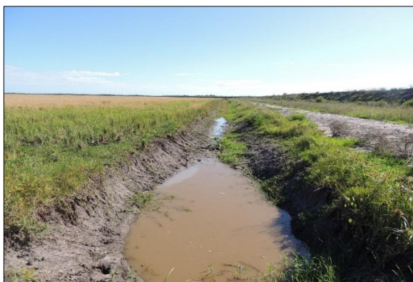
Imagen N° 74: Desagüe principal. Fuente: Propia.
