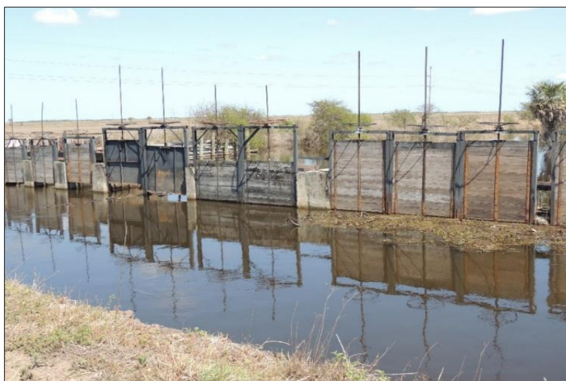
Imagen N°13: Sistema de Compuertas. Fuente: Propia.
