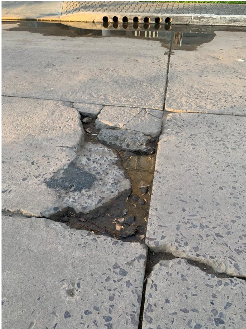
Figura A-2.5. Agrietamientos y desprendimientos profundos, movimiento relativo de losas y formación de baches aislados sobre la Av. Alvear (fuente: Elaboración propia).
