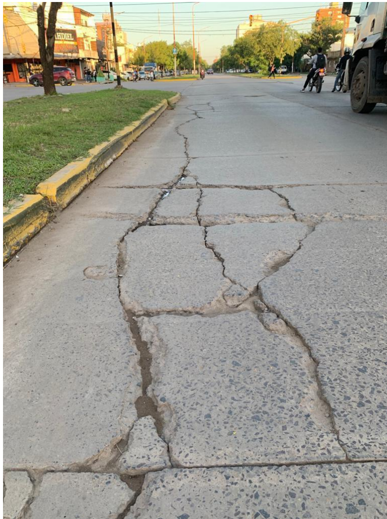
Figura A-2.4. Agrietamientos longitudinales de gran magnitud, con desprendimiento superficial sobre la Av. Alvear (fuente: Elaboración propia).
