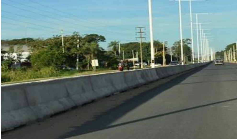
Figura 6.5. Separadores de hormigón tipo New Jersey (fuente: Imágenes de Google).
