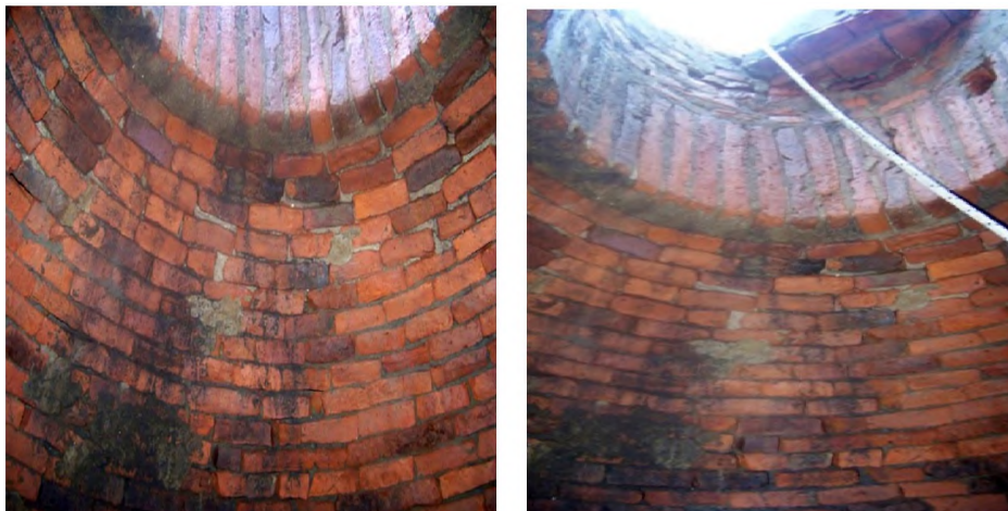
Fotos 54 y 55. Foto detalle del interior del pozo, donde se puede observar la forma abovedada del cuerpo del pozo. (Fotos: Lic. Belén Aguirre)
