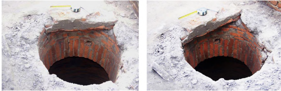
Foto 34 y 35. Fotos del nivel 5, detalles de la mancha de óxido en el sector S-W, en el borde del pozo. (Fotos Lic. Belén Aguirre)
