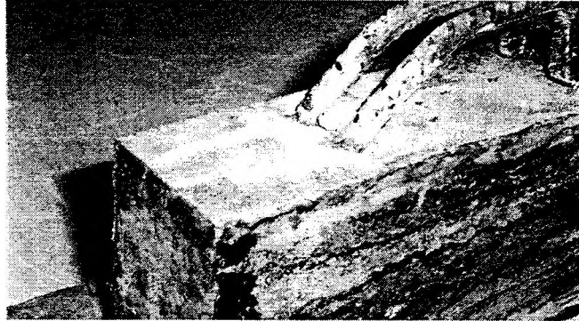
Figura N° 3: Vista de conectores con indicios de corrosión localizada.
