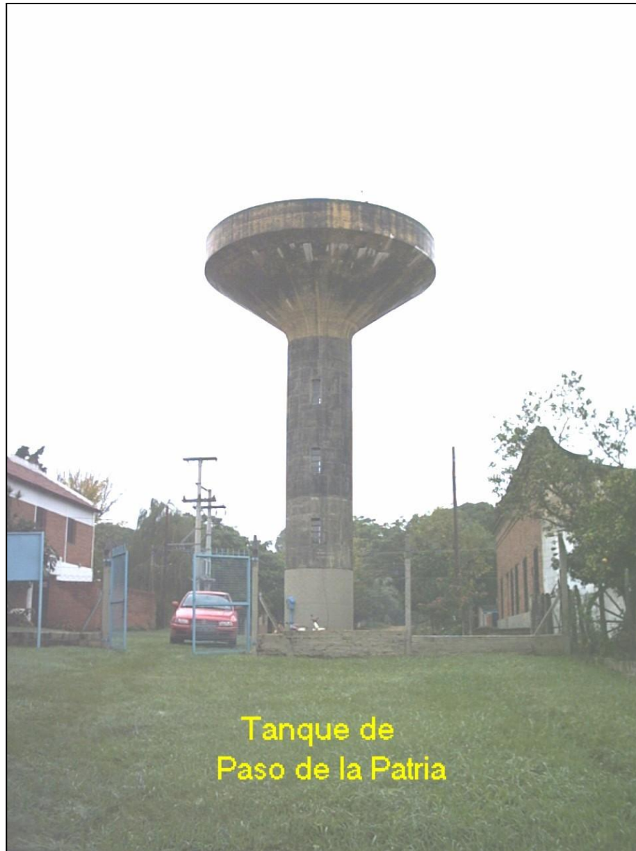
Figura 14. Tanque Elevado. (Fuente: Imagen proporcionada por la Co.Ve.Sa.).
