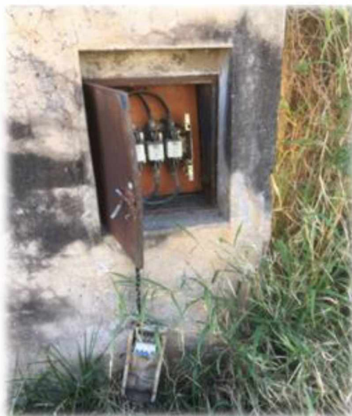
Figura 25. Caja de electricidad del predio. Fuente: Obtención propia
