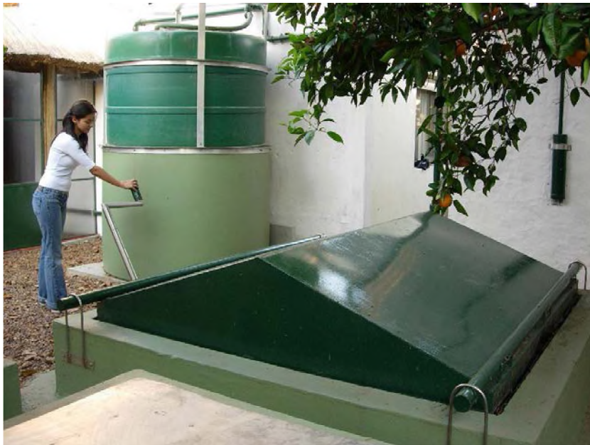
Figura 2. Foto de una instalación de biogás construida por la Fundación Proteger . Fuente: www.proteger.com.ar
