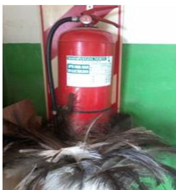
Matafuegos ubicado en el sector de limpieza
