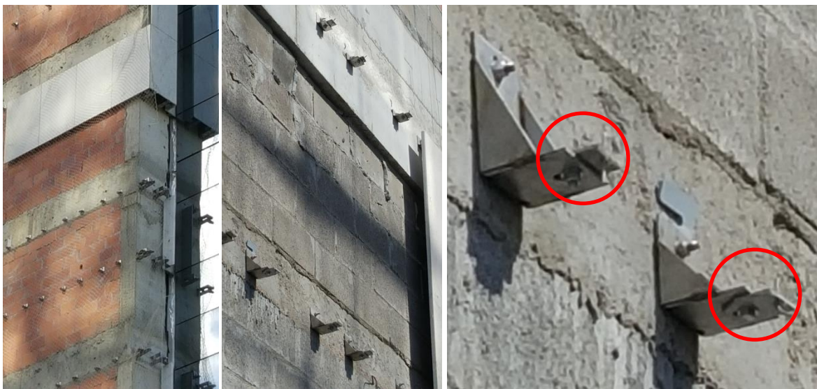
Figura 14. Danos causados pelo downburst e sistema de suporte das placas de granito.
