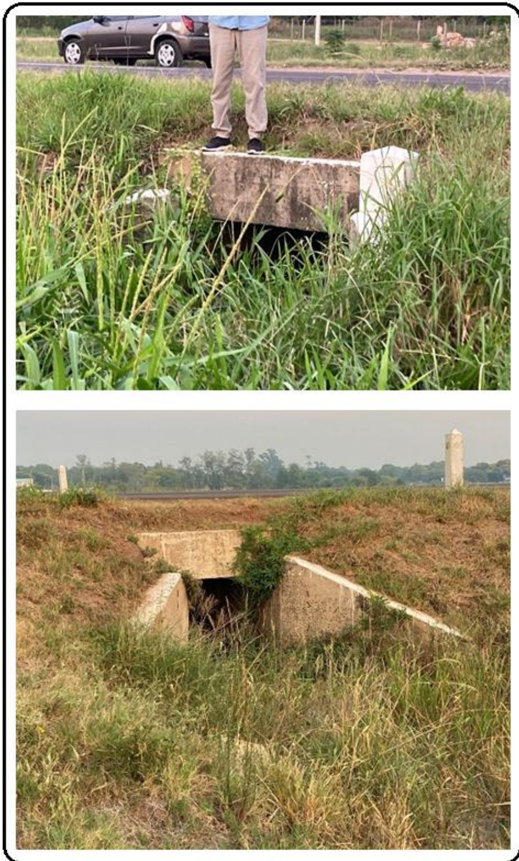
Figura 1.8 – Presencia de maleza en la embocadura de las alcantarillas – Fuente: Relevamiento del grupo.
