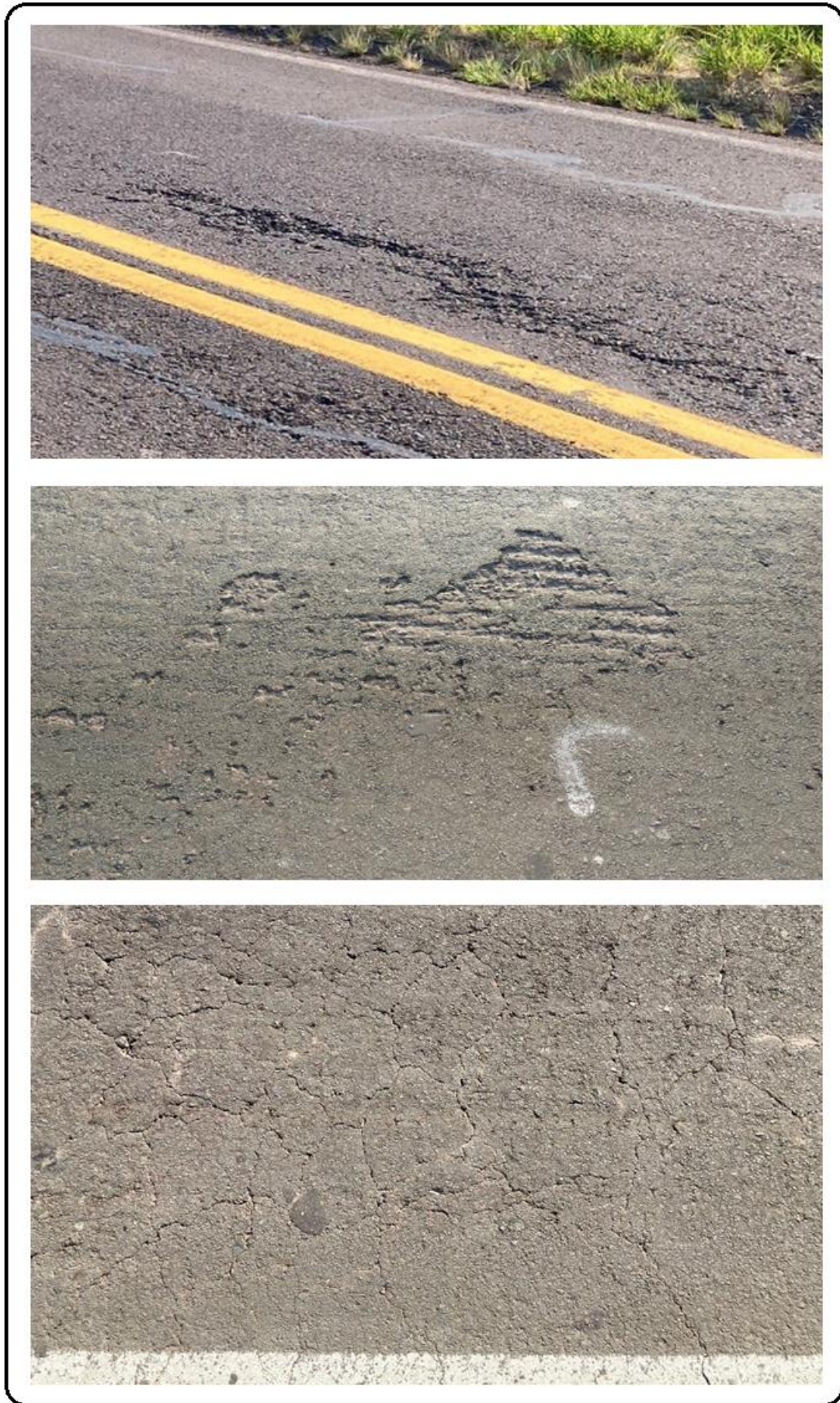
Figura 1.7 – Desprendimientos y fisuras – Fuente: Relevamiento del grupo.
