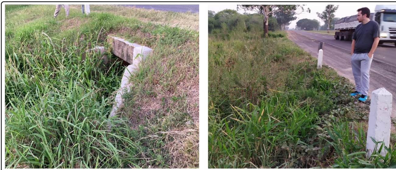
Figura 6.20 – Estado general de conservación de las alcantarillas del tramo – Fuente: Relevamiento del grupo.
