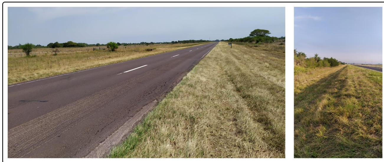
Figura 6.21 – Estado general de conservación de las cunetas del tramo – Fuente: Relevamiento del grupo.
