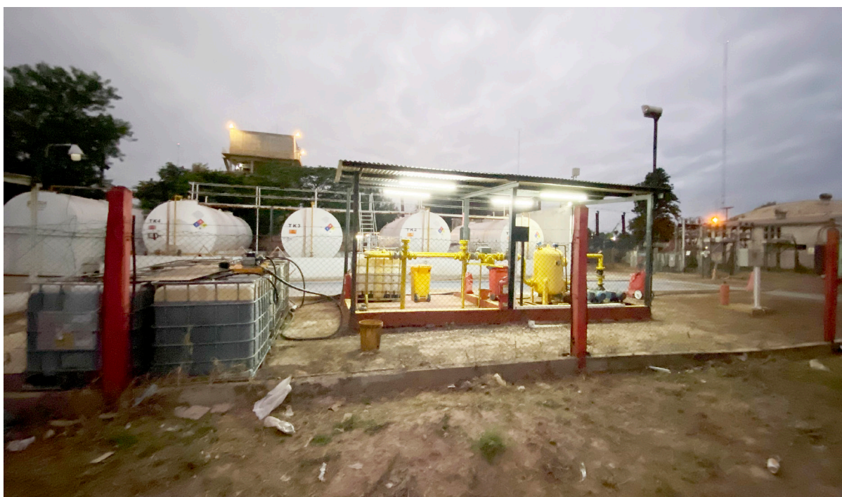
Figura 2b. Planta de generación diésel aislada del sistema interconectado nacional en la localidad de Nueva Pompeya. (Hugo Zurlo)
