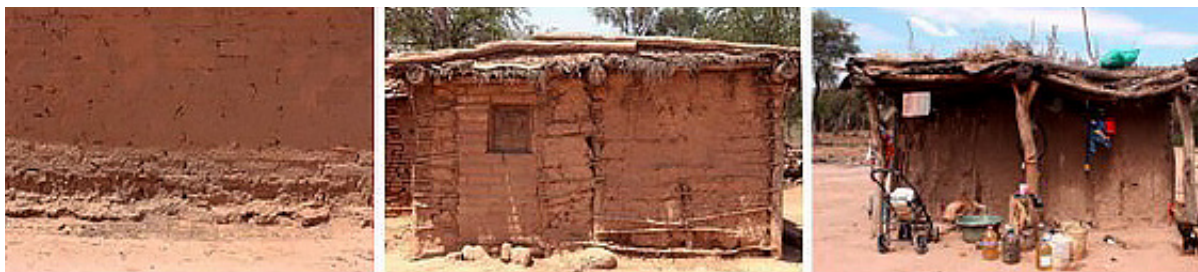
Figura 29. Patologías constructivas de viviendas autóctonas. Ejemplos de patologías constructivas de la vivienda autóctona (Informe diagnóstico hacia soluciones habitacionales en el Gran Chaco, 2016).
