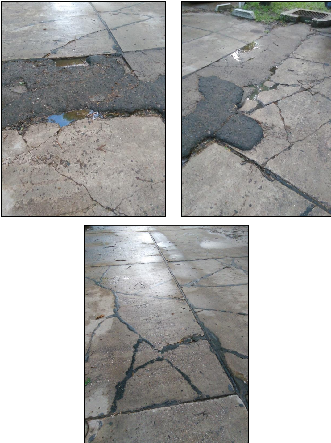
Fotografía n° 3. fisuras en el pavimento en los tramos 6 y 8. (fuente: elaboración propia)
