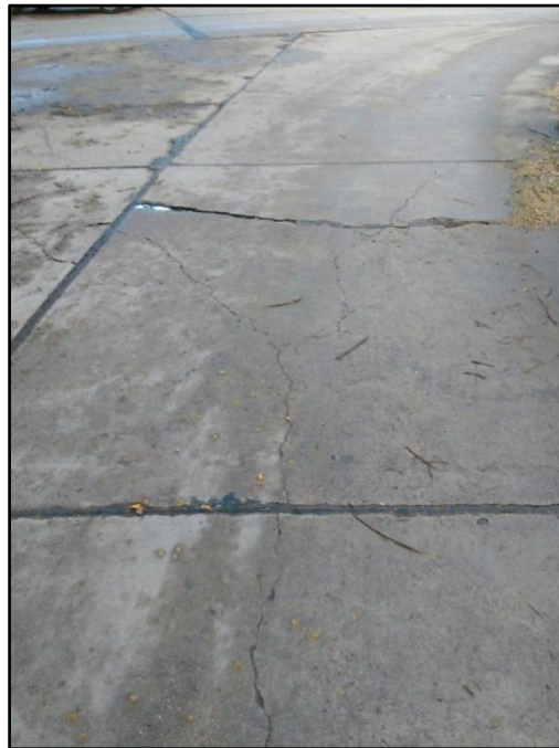
Fotografías n° 1: fisuras en el pavimento en los tramos 1, 3, 7, 9. (fuente: elaboración propia)
