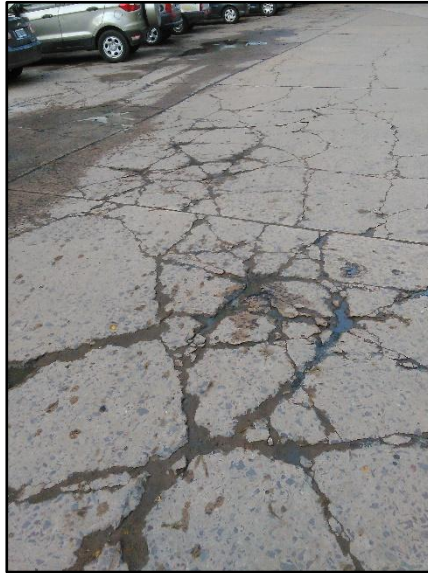
Fotografía n° 2. Fisuras en el pavimento en los tramos 2 y 4. (fuente: elaboración propia)
