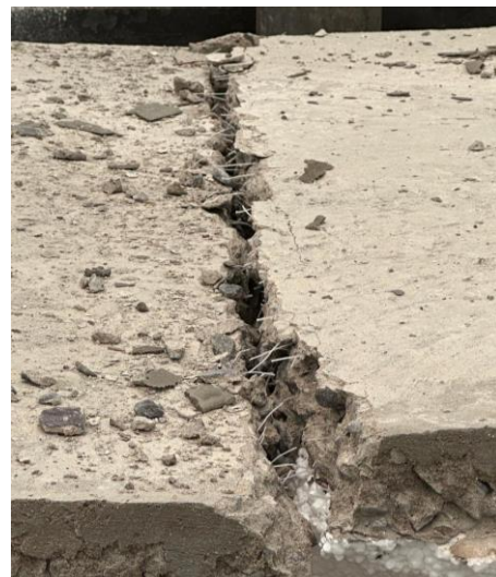
Fig. 2.27. Modo de rotura Forjado N°2
