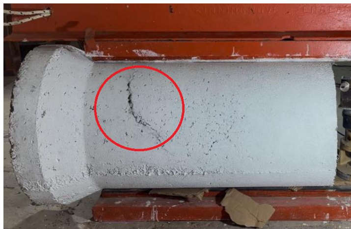
Fig 3.29 - Fisura preexistente (40 - 4,5 - 100 - F)
