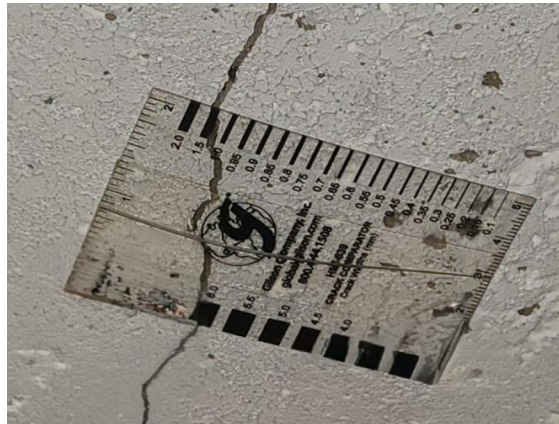
Fig 3.36 - Medición del ancho de fisura
