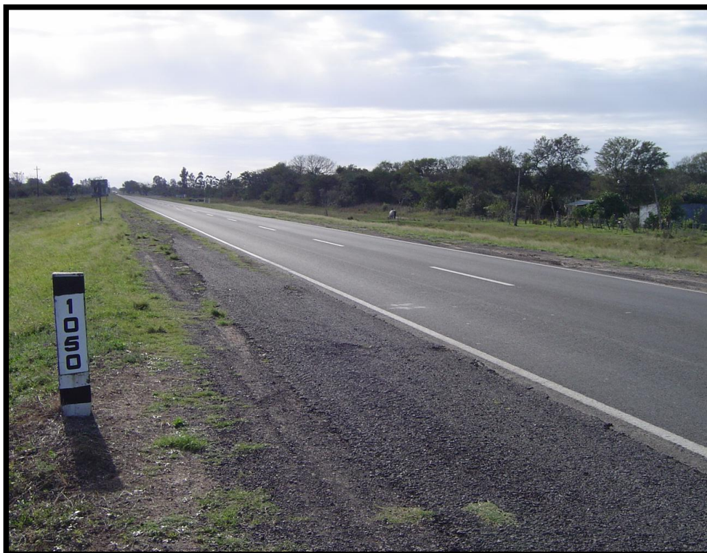
Imagen 6. Banquina con mezcla asfáltica en mal estado
