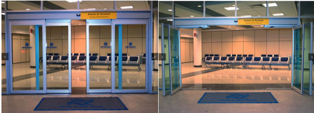
Figura V-8. Puertas corredizas automáticas de evacuación. Sistema antipánico (fuente: Manusa)
