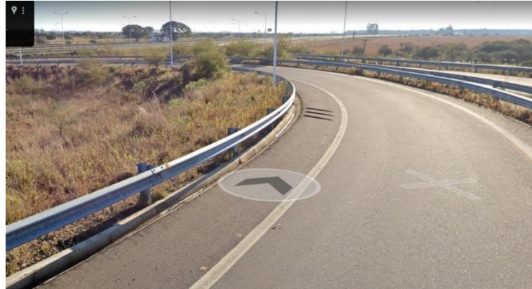
Figura 90. Imagen ilustrativa de cordón cuneta de H° A° en una trompeta
