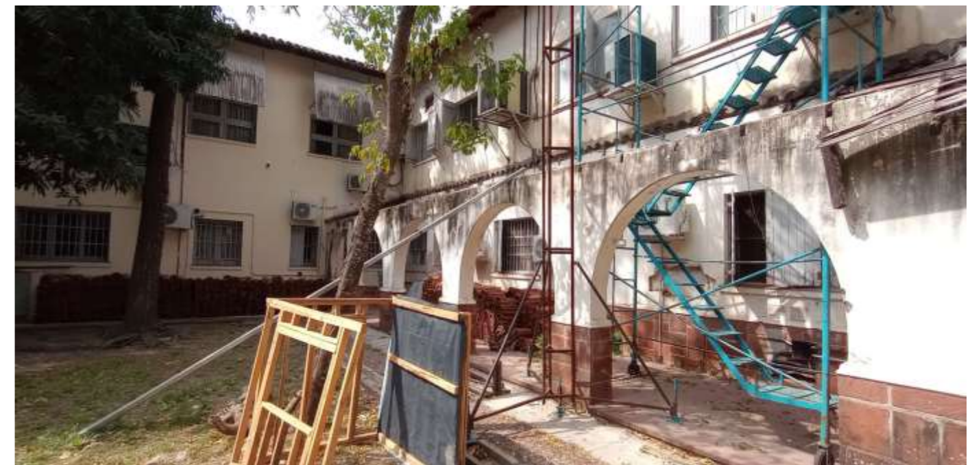
Figura 78: Acopio de Materiales y estado de galerías internas frente de los patios internos centrales de Arquitectura y Ciencias Económicas .
