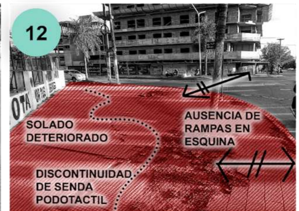
Ref. 12: Esquina Av. Las Heras y Av. Castelli: La vereda se encuentra deteriorada y carece de rampas para el acceso o bajada por las esquinas.
