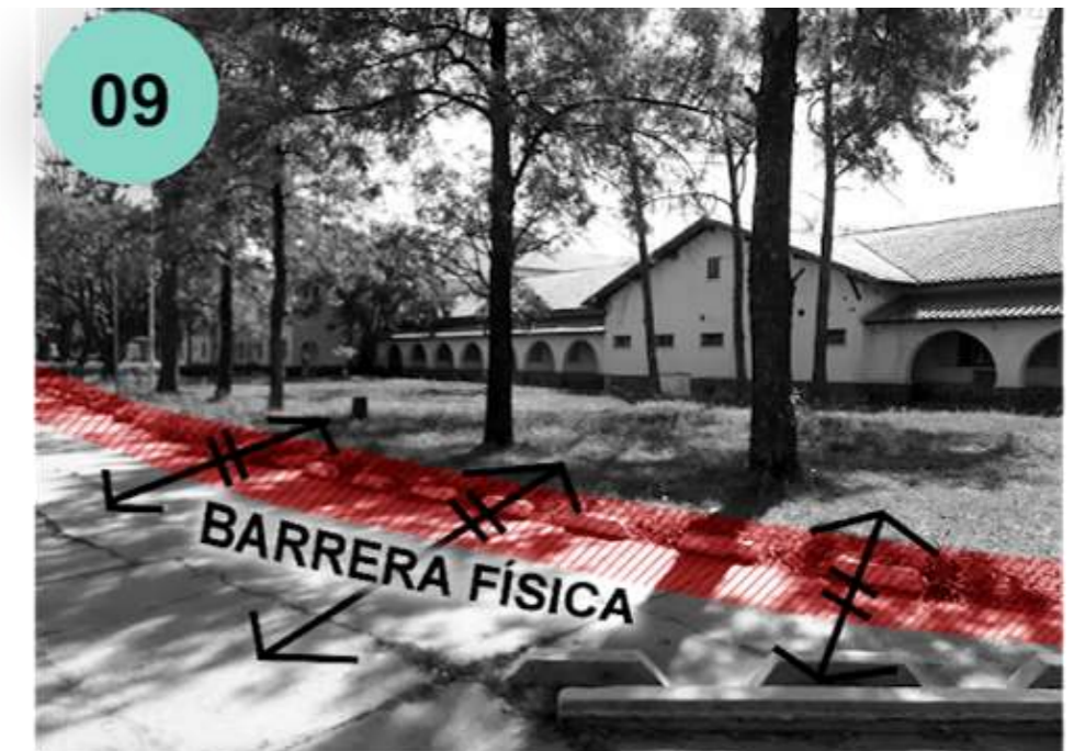
Ref. 09: Patios que rodean los edificios.: Se encuentran cercados por un cordón que impide el libre desplazamiento hacia los patios.
