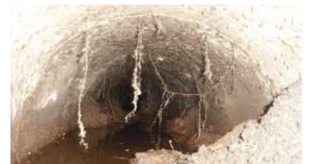
Fig. 109. Raíces de los árboles en el interior de los caños de desagüe pluvial. Fuente: Instituto de Campus unne.
