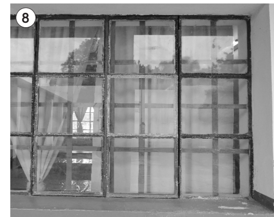
Aberturas defectuosas por antigüedad.
