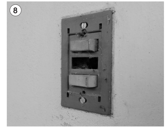
Artefacto eléctrico defectuoso e inseguro.
