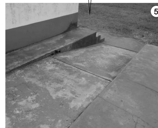
Rampa de accesibilidad sin continuidad constructiva.
