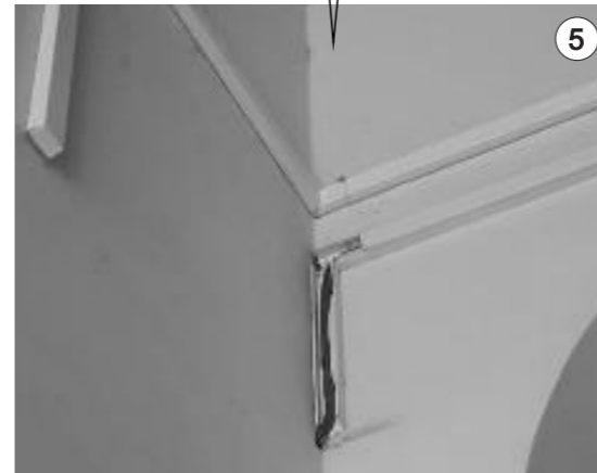
Instalación eléctrica antigua defectuosa.
