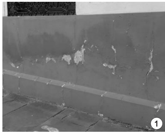
Desprendimiento de revestimiento por humedad.
