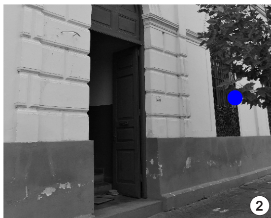
Aberturas defectuosas por antigüedad.
