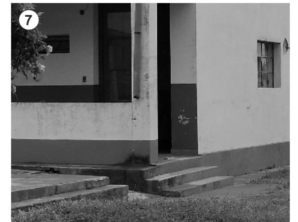
Deságües pluvial incompleto defectuoso.
