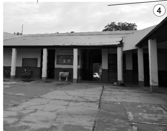
Canaletas desbordadas y sin continuidad de instalación pluvial.
