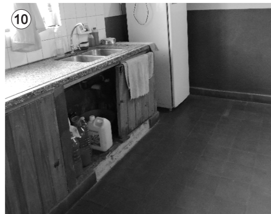
Materiales combustibles y anti higiénicos en servicios.
