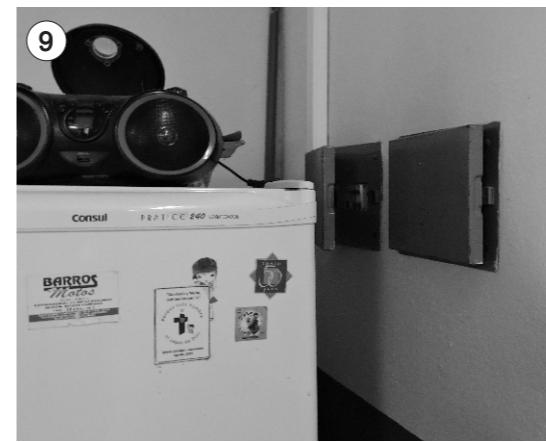
Incorrecta y peligrosa ubicación de tablero general.
