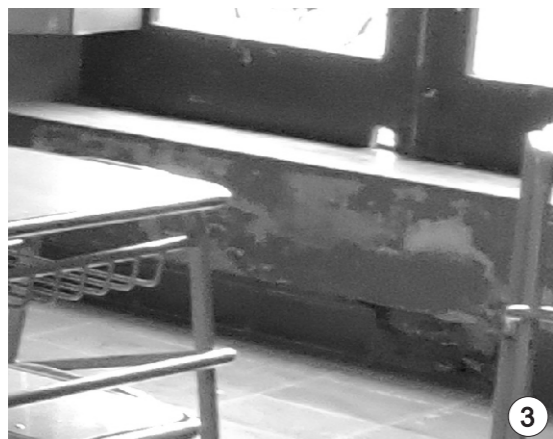
Manchas y descascaramiento de pintura por humedad y desprendimiento de zócalos.
