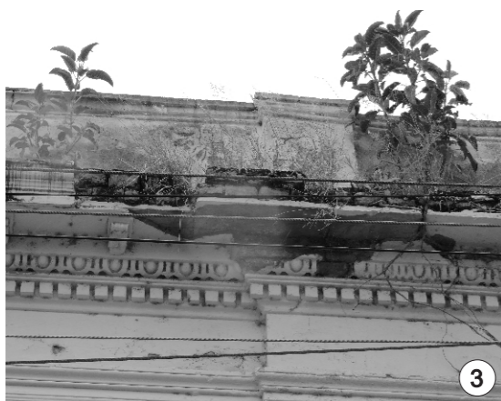
Desprendimiento y caída de cornisa, vegetación arraigada en la estructura.
