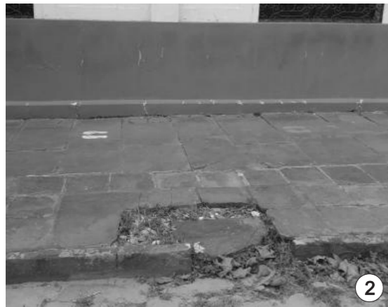
Hundimiento y desprendimiento de laja de piedra.
