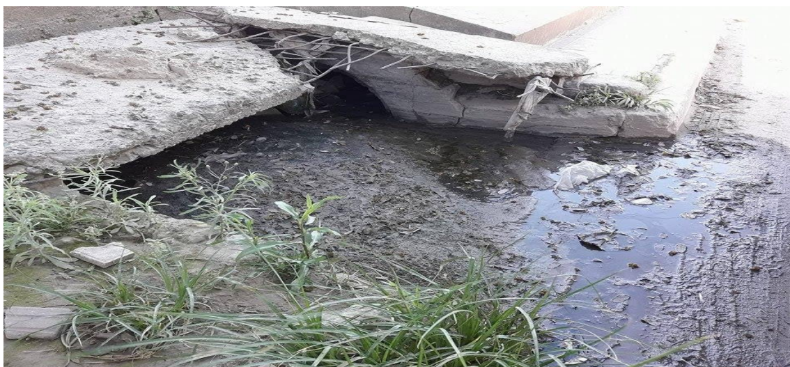
Fig. 24: Desagüe en malas condiciones (fuente: Elaboración propia).
