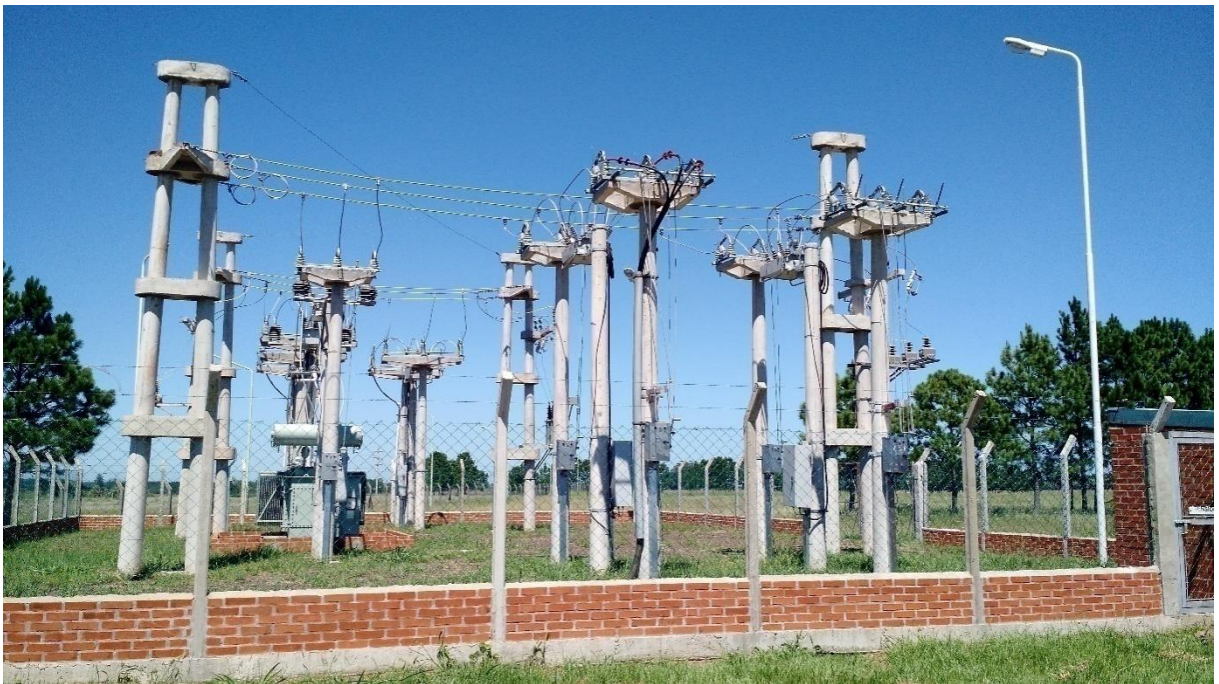
Fotografía 5. Estación transformadora que alimenta la red interna. (Fuente propia).
