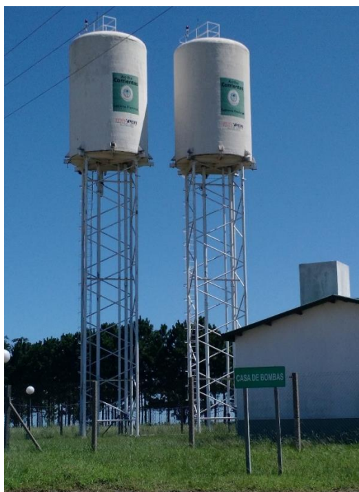
Fotografía 3. Tanques de alimentación de la red de agua potable. (Fuente: elaboración propia).
