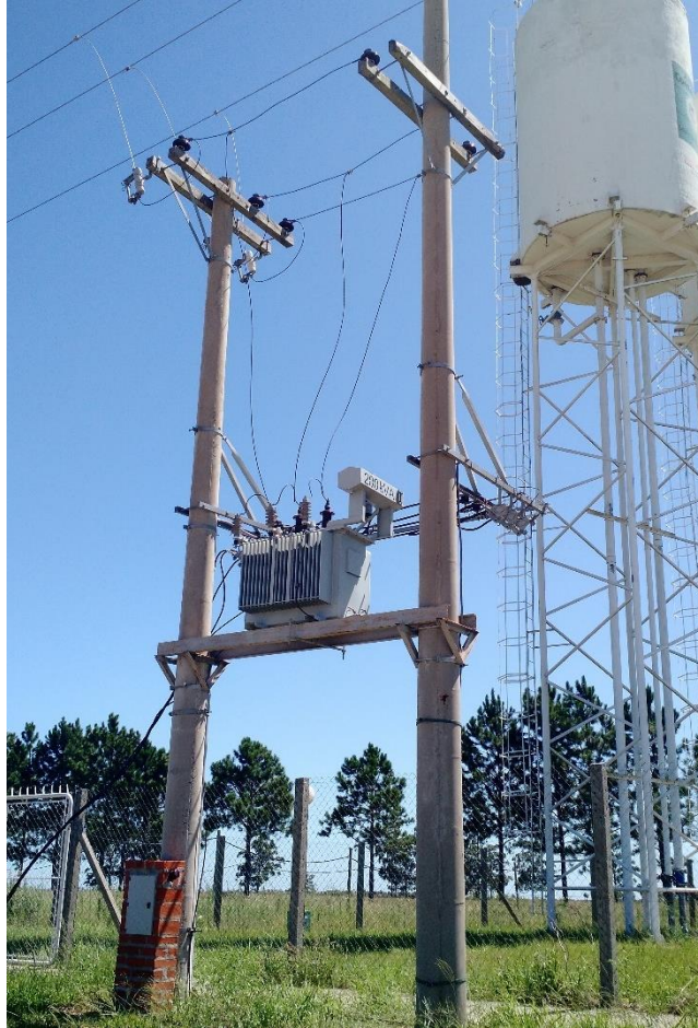
Fotografía 4. Transformador de 200kVA de la red de energía eléctrica interna. (Fuente: elaboración propia).
