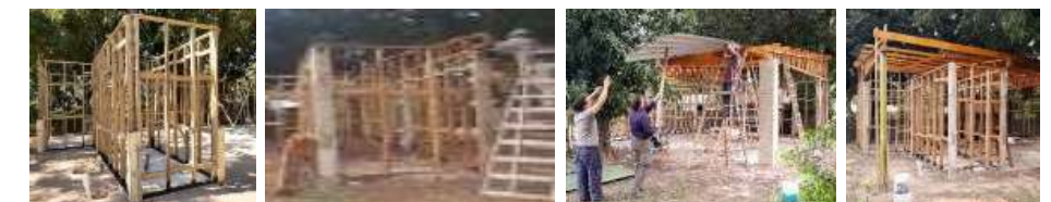
Fig. 9: Montaje de los paneles verticales sobre el basamento (izq.). Montaje de la cubierta (der.). Ejecución con tres operarios, sin herramientas, ni maquinarias especiales. Fuente: fotos propias de los autores, verano 2021-2022.
