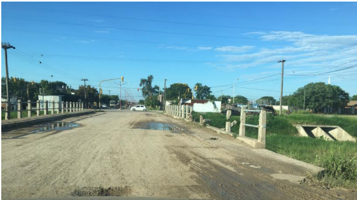
Figura 82. Daños en la calzada (Relevamiento propio).
