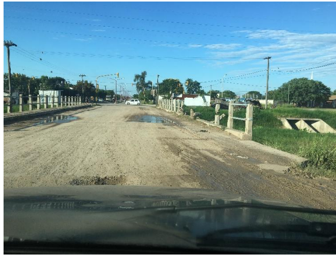
Figura 22: Deterioros y obsolescencias en los puentes (fuente: elaboración propia)
