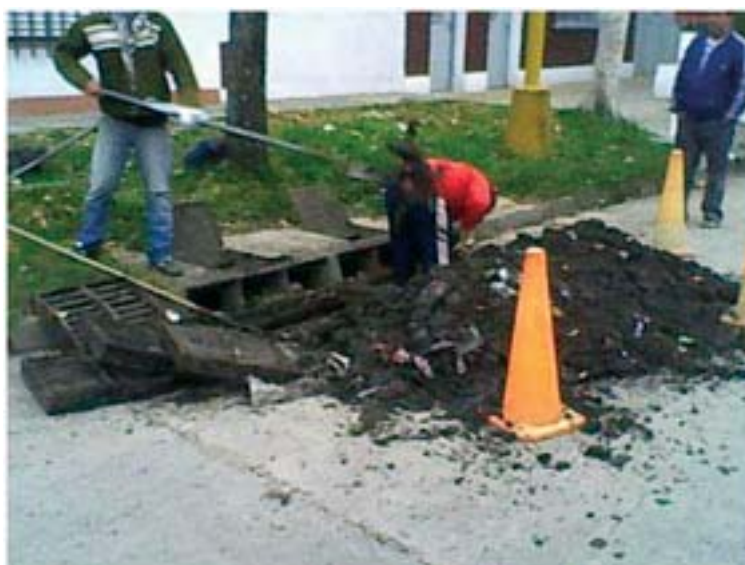
Figura 5. Aumento de costos de mantenimiento - Calle Gdor J.R.Gómez y Pje. Olazabal ciudad de Corrientes. (Fuente: propia 2011)
