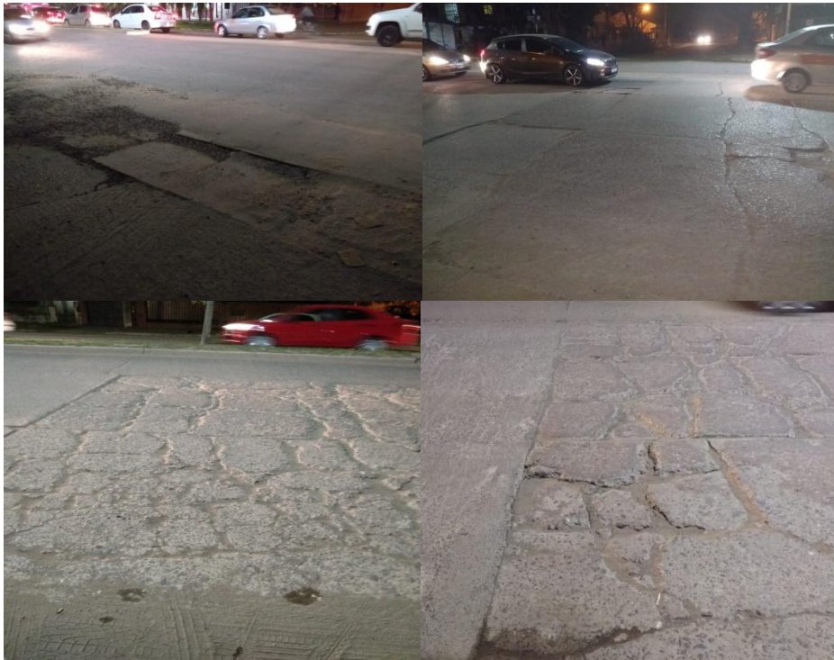
Figura I.4. Daños en calzada en avenida 9 de Julio altura 2.300-2.500. (Fuente: elaboración propia)
