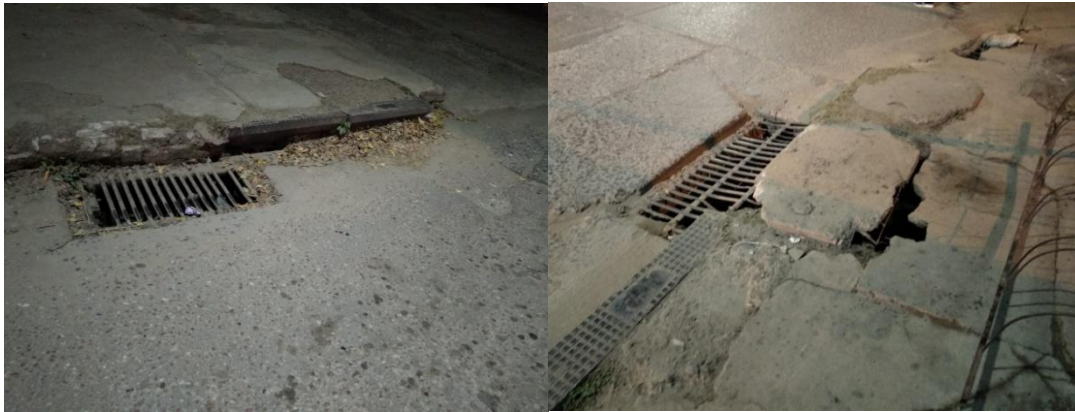
Figura VII.4. Imbornales en mal estado en la avenida 9 de Julio altura 2.400. (Fuente: Elaboración propia)
