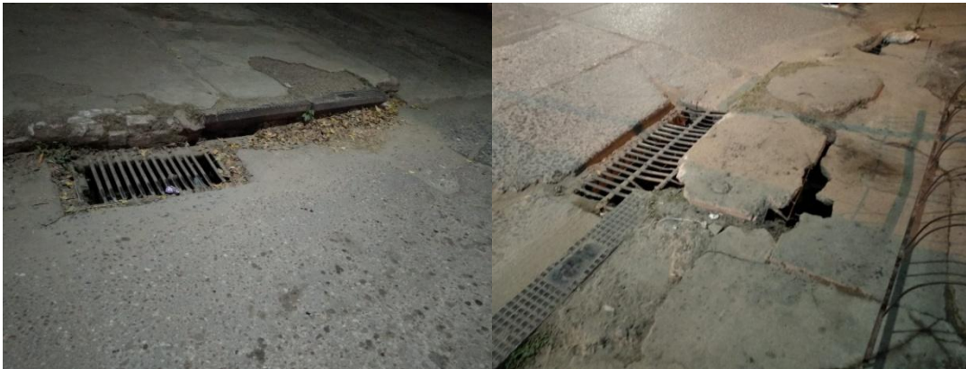
Figura I.9. Imbornales en mal estado en la avenida 9 de Julio altura 2.400. (Fuente: elaboración propia)
