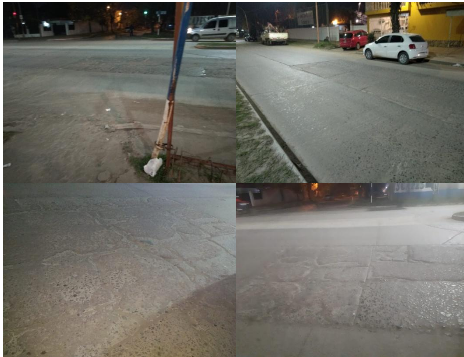
Figura I.5. Daños en calzada en avenida 9 de Julio altura 2.300-2.500. (Fuente: elaboración propia)
