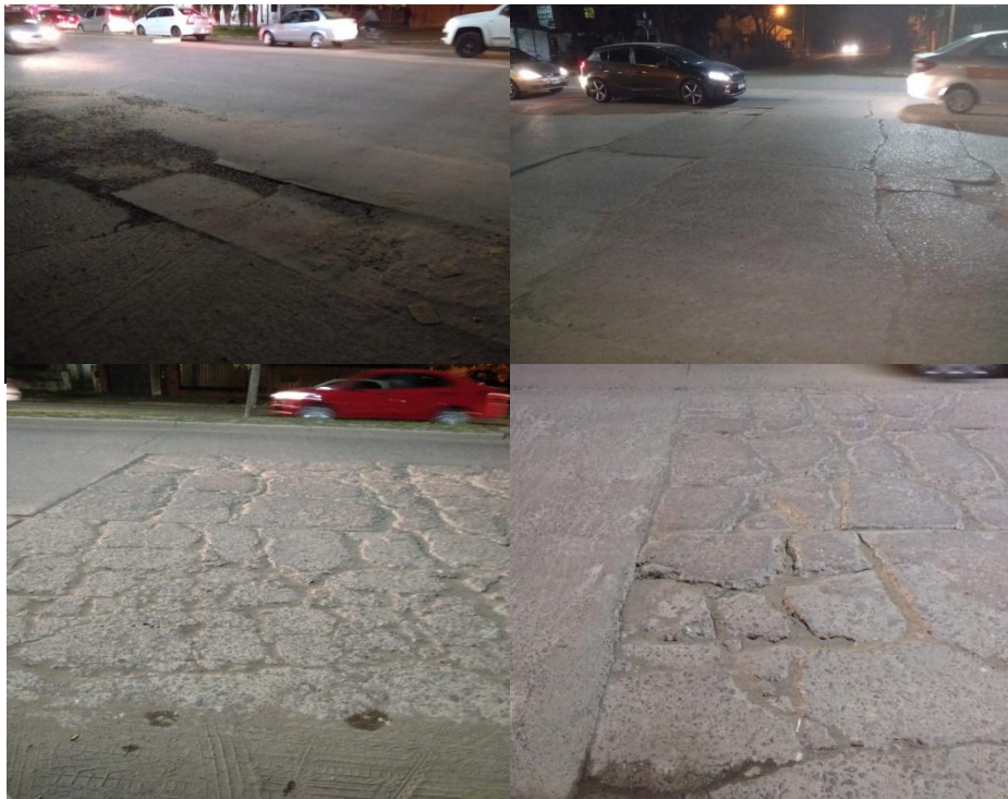
Figura VI.2. Daños en calzada en avenida 9 de Julio altura 2300-2500. (Fuente: elaboración propia)
