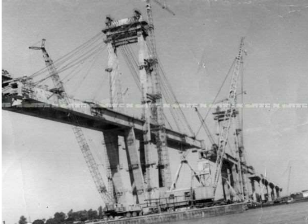
Fig. 5. Fotografía de etapa más avanzada de la construcción del Puente General Manuel Belgrano.
