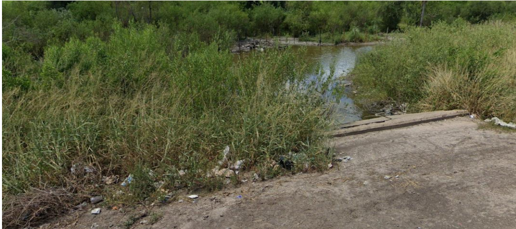
Imagen 4.9: alcantarilla 3. Sección rectangular. Obstruida por residuos. - (Fuente: Google Earth Pro).
