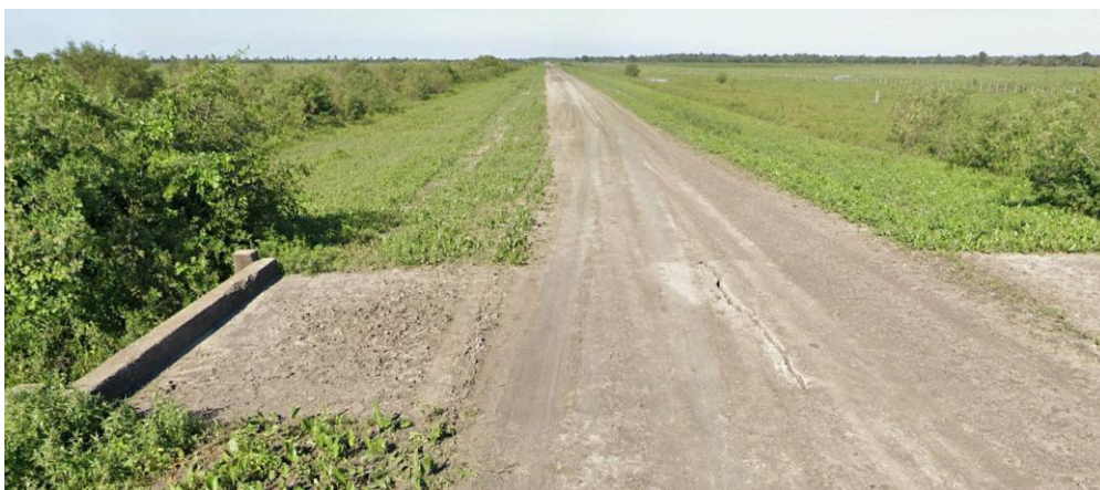
Imagen 4.14: alcantarilla 117. Sección rectangular. Fisura en la losa. - (Fuente: Google Earth Pro).
