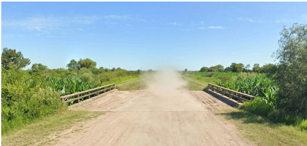
Imagen 4.13: alcantarilla 52. Sección rectangular y con barandas. Sobre el brazo norte del Río Tapenagá. - (Fuente: Google Earth Pro).
