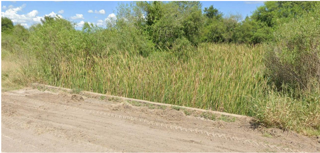
Imagen 4.10: alcantarilla 26. Sección rectangular. Obstrucciones debidas a la densa vegetación y falta de mantenimiento. - (Fuente: Google Earth Pro).
