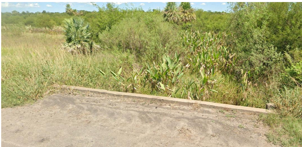
Imagen 4.11: alcantarilla 30. Sección rectangular. Obstrucciones debidas a la densa vegetación y falta de mantenimiento. - (Fuente: Google Earth Pro).
