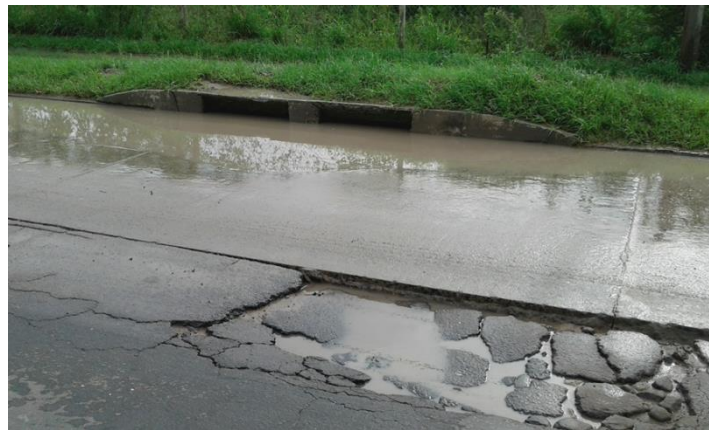
Figura A.7. Desprendimientos de la calzada. (Fuente: elaboración propia)
