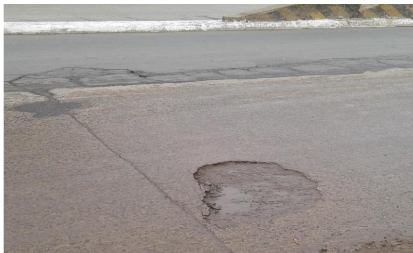
Figura 1.12. Deterioros de la capa de rodamiento. (Fuente: elaboración propia.)
