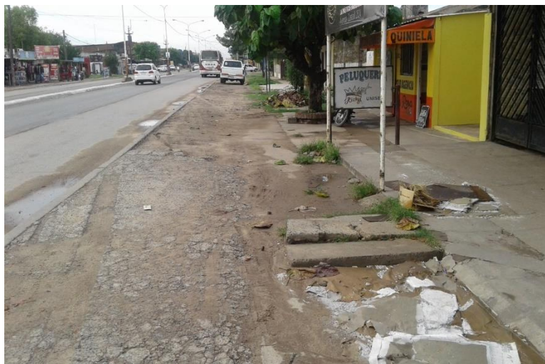
Figura A.5. Veredas en mal estado sobre la avenida. (Fuente: elaboración propia)
