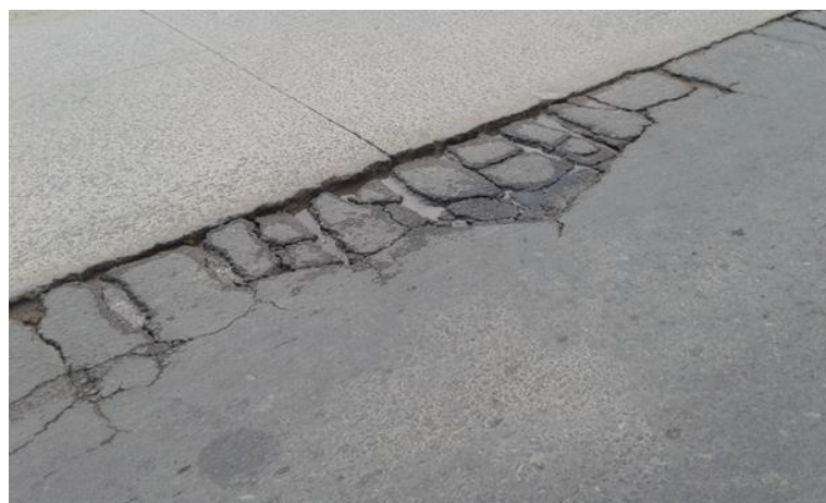
Figura A.8. Deterioro de calzada en la vía estudiada. (Fuente: elaboración propia)
