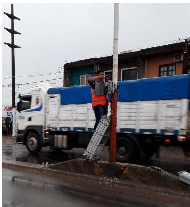
Figura A.18. Instalación del contador electrónico sobre av. Castelli en Resistencia. (Fuente: DVP)
