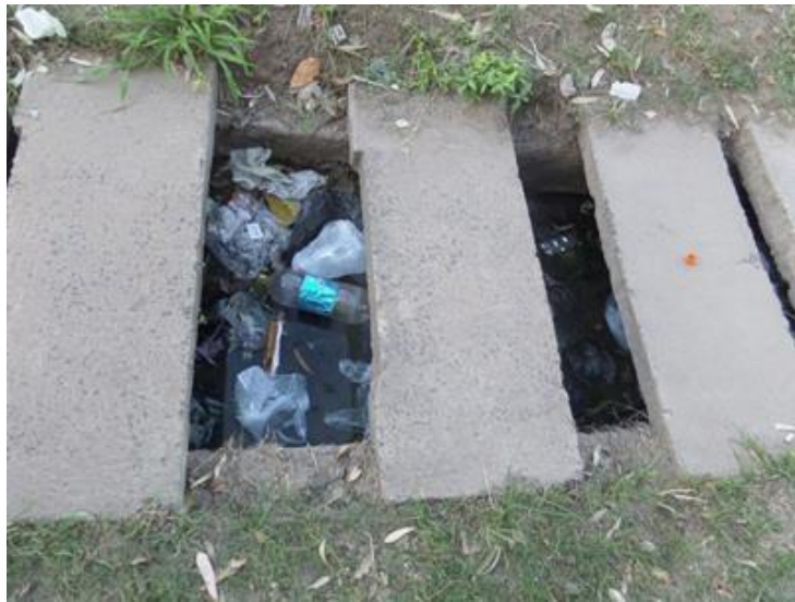
Figura A.6. Sistema de desagües estañados con basura. (Fuente: elaboración propia)
