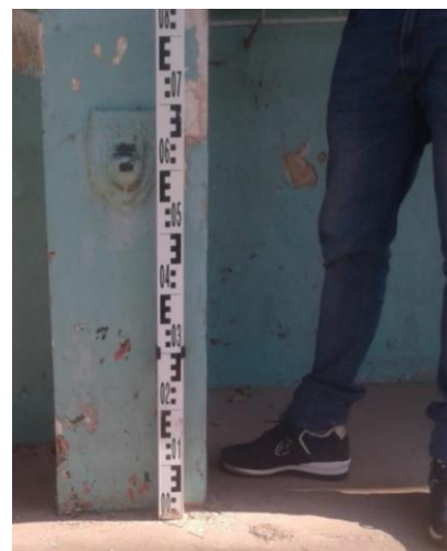
Figura 3.4. Ubicación de la regla en el punto fijo de OSN de la "Escuela N° 675" (Fuente: elaboración propia.)
