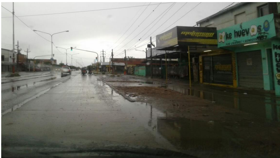
Figura 1.14. Cordón cuneta inexistente. (Fuente: elaboración propia.)
