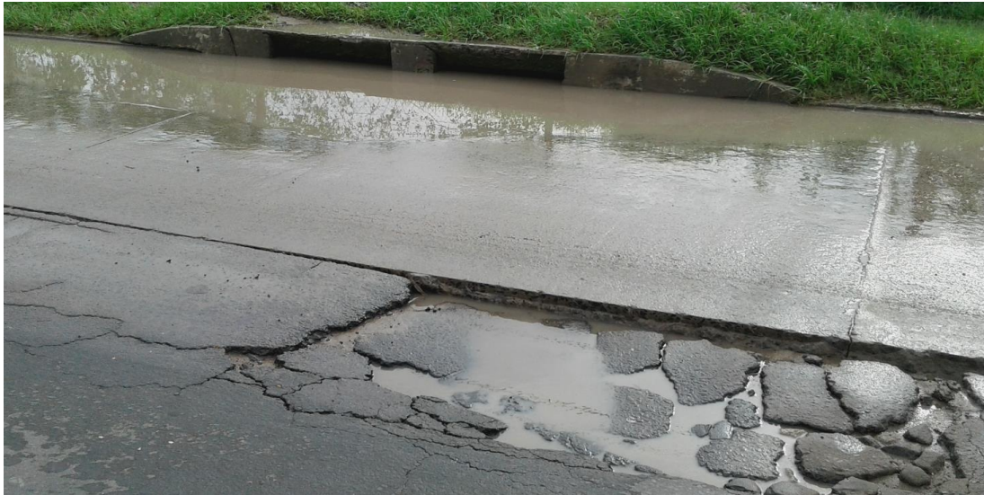
Figura 1.13. Deterioros de la capa de rodamiento con acumulación de agua. (Fuente: elaboración propia.)
