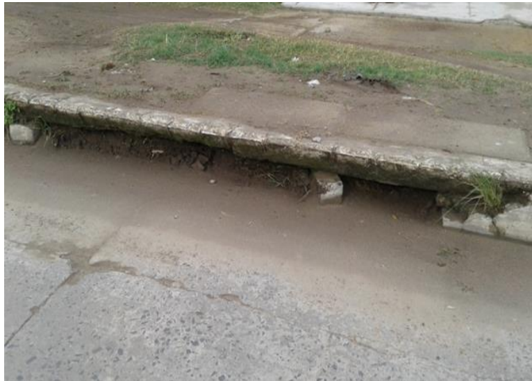
Figura A.4. Sumideros deteriorados y bloqueados con tierra sobre el tramo de estudiado. (Fuente: elaboración propia)
