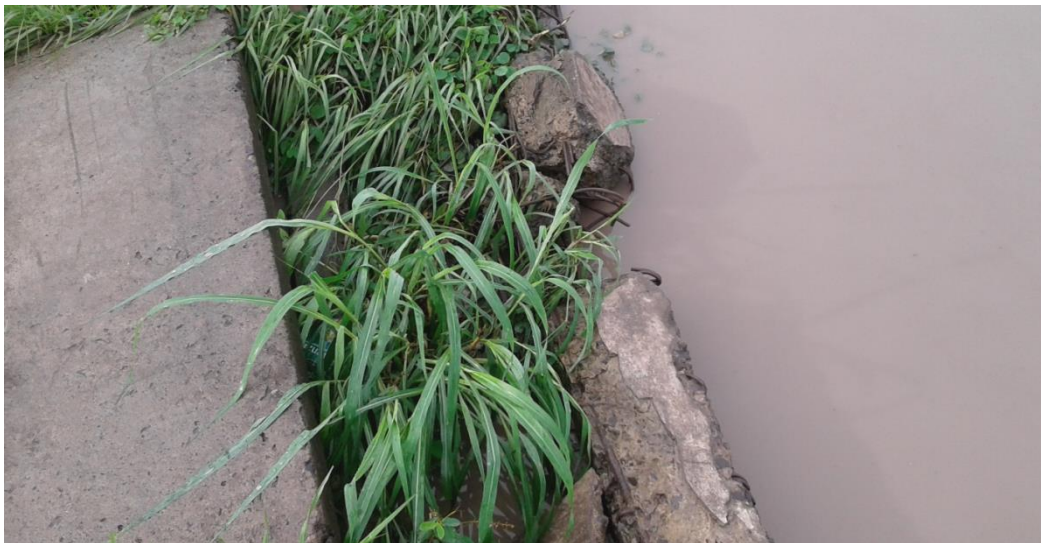
Figura 1.16. Imbornales cubiertos con vegetación. (Fuente: elaboración propia.)
