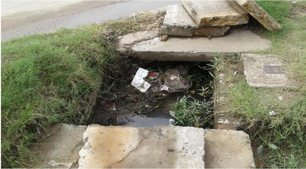
Figura 1.15. Sistema de desagüe pluvial afectado por la concentración de basura. (Fuente: elaboración propia.)
