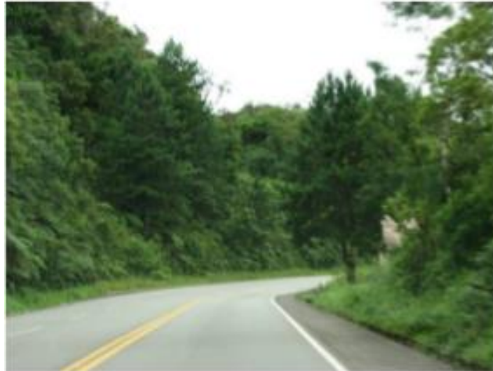
Figura 5.1: Vegetación dificultando la visión del conductor. Zona peligrosa.
