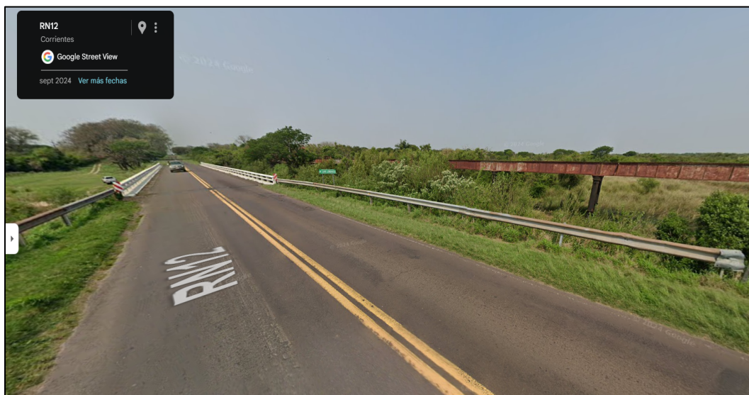
Figura 8.23. Incumplimiento de la longitud mínima de la protección lateral en el tramo en estudio. Fuente: Adaptado del sitio web de Google Maps, 2025.
