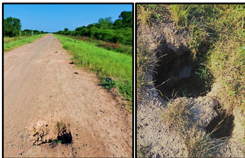
Figura 5.9 Hundimientos en terraplén de defensa del AMGR (Fuente: elaboración propia).
