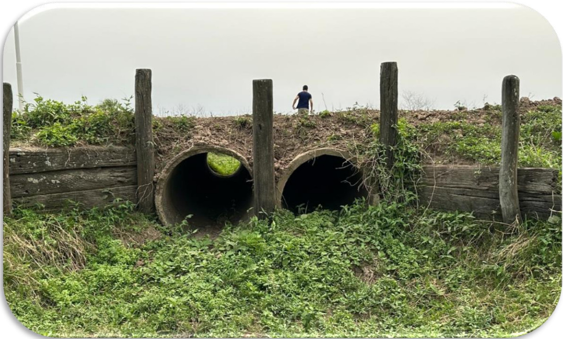
Imagen 7.28: Alcantarilla prefabricada 2\varnothing = 1.00\text{m} - (Fuente: Elaboración propia)
