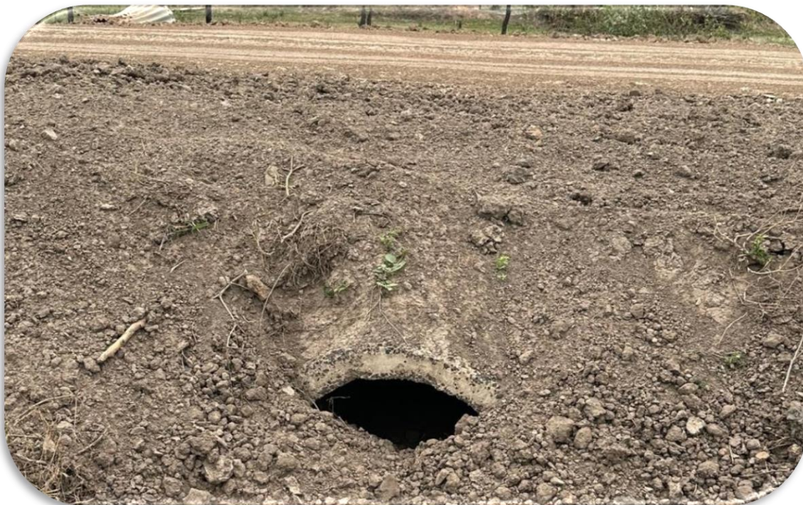
Imagen 7.30: Alcantarilla prefabricada \varnothing=0.80\text{m} totalmente obstruida - (Fuente: Elaboración propia)
