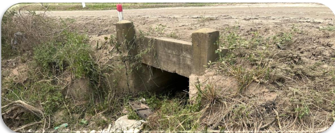
Imagen 7.31: Alcantarilla de hormigón armado de 1m x 1.50m - (Fuente: Elaboración propia)
