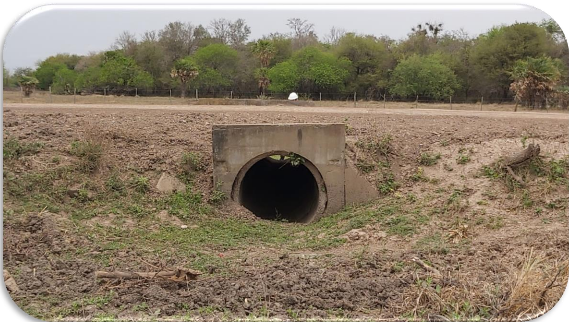
Imagen 7.29: Alcantarilla prefabricada \varnothing = 1.00\text{m} - (Fuente: Elaboración propia)
