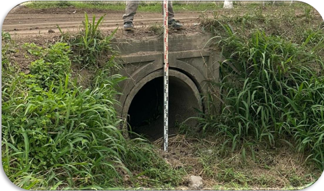
Imagen 7.26: Alcantarilla prefabricada \varnothing = 0.80\text{m} . En las cercanías de Samuhú-(Fuente: Elaboración propia)
