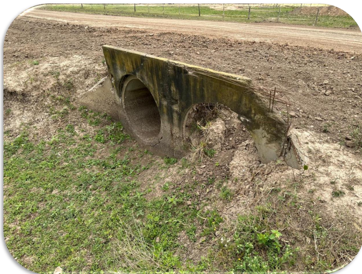
Imagen 7.33: Alcantarilla de hormigón armado \varnothing = 0.80\text{m} destruida - (Fuente: Elaboración propia)
