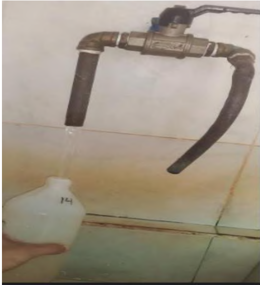
Imagen N°: 3 toma de muestra (agua cruda) proveniente de toma de captación profunda.
