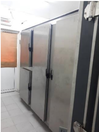
Cámara de frío
