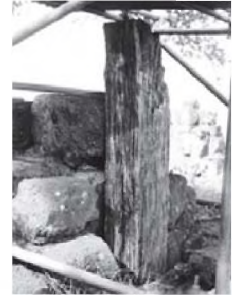
Pilar de madera usado en el sistema independiente. Foto Villegas (s.f.)
