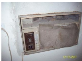
Foto 8 – Archivo FCA UNNE – Equipo de Aire Acondicionado – Ana Ruzich – Silvana Del Rio – Elida Núñez – 12/12/2011
