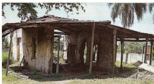
Foto 4. Casa Familiar Gernaldi. Antes de su recuperación.
