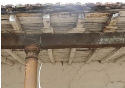
“Entacuarado” sobre tirantería, barro y tejas. Se observan también tacos de madera para lograr nivelación de cubierta
