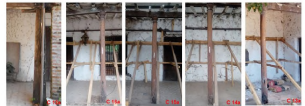
Poste de eucalipto en remplazo de la inexistente columnas C 12a Fustes de columnas C 13a, C 14a, C 15 a, C 16a con socavamiento de la madera por podrición
