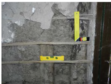
Detalle sector con revoque descubierto, donde se observa estructura principal (maderas verticales) y estructura secundaria (tacuaras horizontales)
