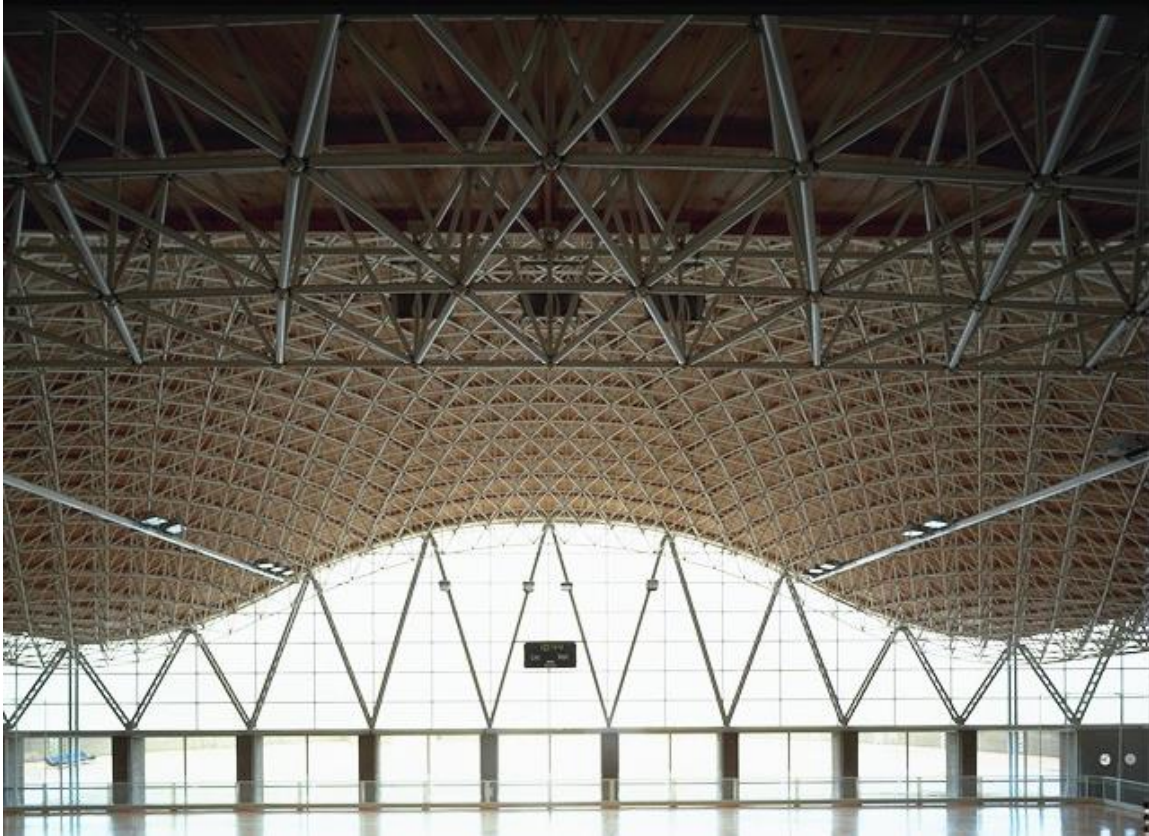
Figuras 6.20 & 6.21. Fotografías de la malla espacial que soporta la cubierta del polideportivo Palafolls.
