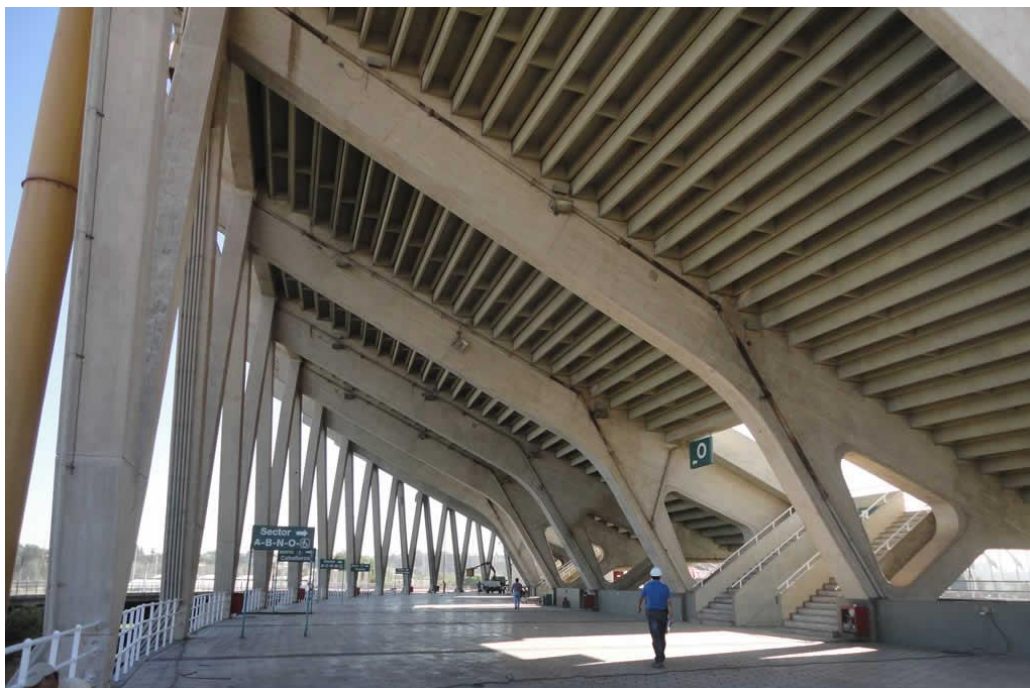
Figura 6.3. Estructura de las gradas del estadio Mario Alberto Kempes. Fuente: sitio web de la empresa Astori
