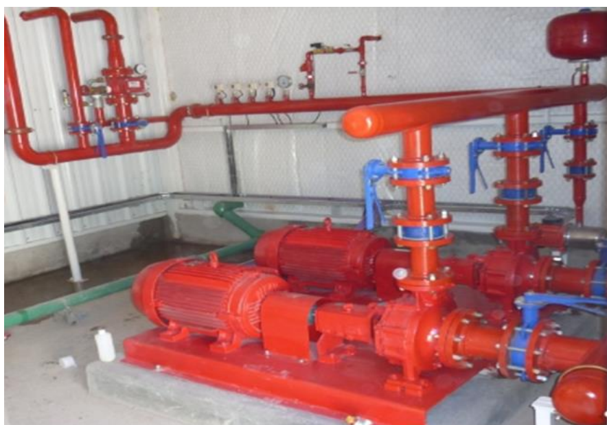
Figura 7.6. Fotografía de un sistema de bombeo contra incendios. Fuente: Cámara Argentina de Seguridad (CAS, 2013).
