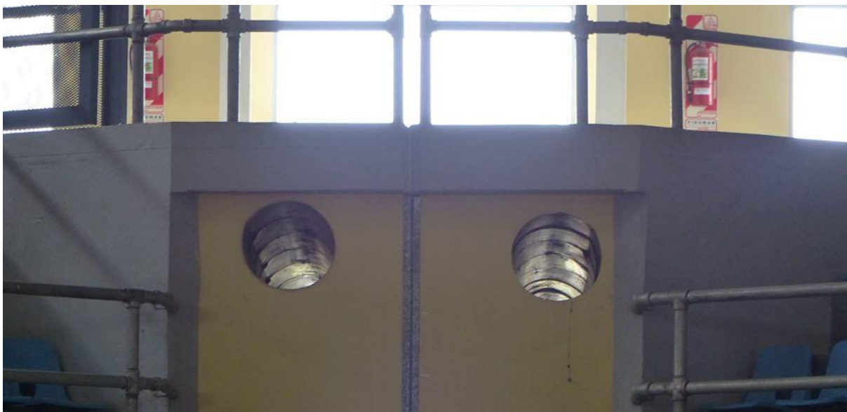
Figura 3.9. Fotografía de los conductos destinados a transportar aire acondicionado (sin conexión a equipos de refrigeración). Fuente: gentileza de Leandro Schenone; estudiante de ingeniería civil de la Universidad Nacional de Formosa.
