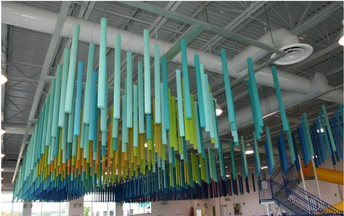
Figura 7.22. Baffles aéreos colgados de la estructura de una cubierta. Fuente: sitio web de la empresa Decibel Sudamericana S.A.. http://www.decibel.com.ar
