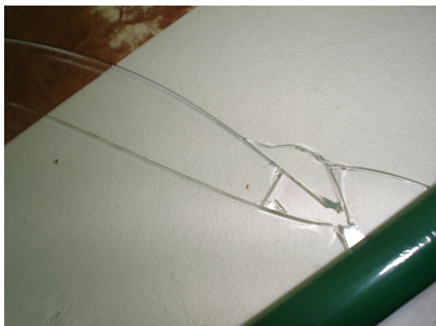
Rotura de vidrios e inestabilidad de enmarque.
