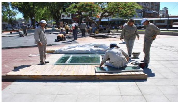
Foto 21. Enero de 2013. Al pozo de agua descubierto en la remoción de tierra y canteros y que fuera parte de los estudios que dieron origen a esta publicación, habiéndose quitado el relleno por 5,60 m. de profundidad, se le coloca un piso de vidrio para ser observado por los transeúntes. El vestigio histórico hallado fue, investigado profundamente por parte de investigadoras pertenecientes al Centro de Estudios Históricos Arquitectónicos y Urbanos de la Facultad de Arquitectura de la Universidad Nacional del Nordeste (UNNE y CONICET). Al ser incorporado a la lectura de la historia de la plaza, se convierte en el único elemento, junto a la estatua de Cabral, que refiere a la memoria histórica al datar los inicios de este patrimonio urbano incluyendo la actual total modificación de este espacio por sexta vez.
